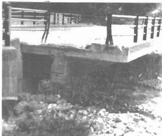
Φωτ. 2: Καταστροφή, από κατολίσθηση, της γέφυρας Βλάσιου.
