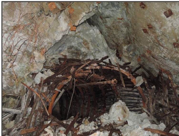
Εικόνα 2.1 Αστοχία βραχώδους σφήνας με ελεύθερη πτώση από την οροφή κατά τη φάση διεύρυνσης και αποκατάστασης της ερευνητικής στοάς -210 του μεταλλείου Ολυμπιάδας.
