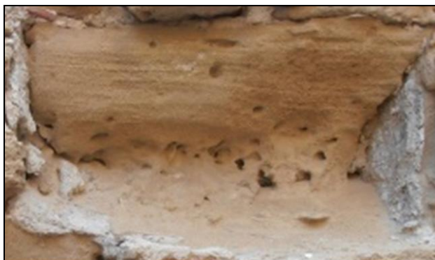
Εικόνα 5.2.11: Μηχανισμός φθοράς τύπου διάτρηση.
