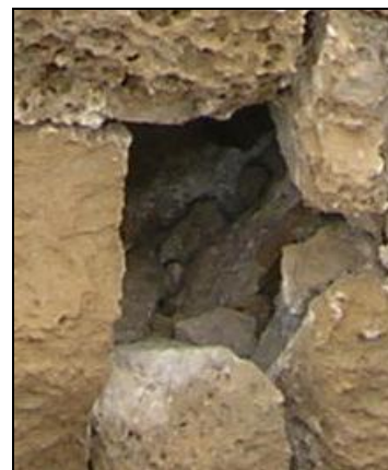
Εικόνα 5.2.14: Μηχανισμός φθοράς τύπου ελλιπών τμήμα.
