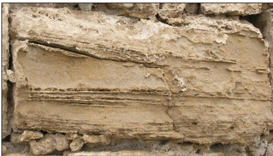
Εικόνα 5.2.8: Μηχανισμός φθοράς τύπου κυψελοειδής διάβρωση.
