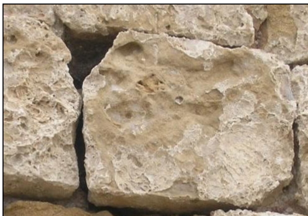
Εικόνα 5.2.13: Μηχανισμός φθοράς τύπου ελλιπών τμήμα.
