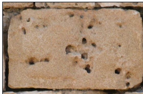
Εικόνα 5.2.12: Μηχανισμός φθοράς τύπου διάτρηση.
