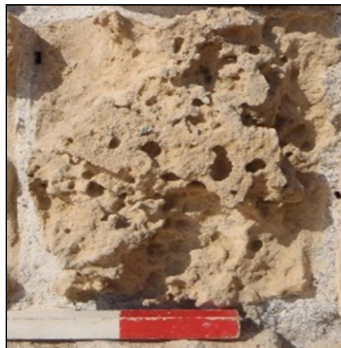
Εικόνα 5.2.10: Μηχανισμός φθοράς τύπου διάτρηση.
