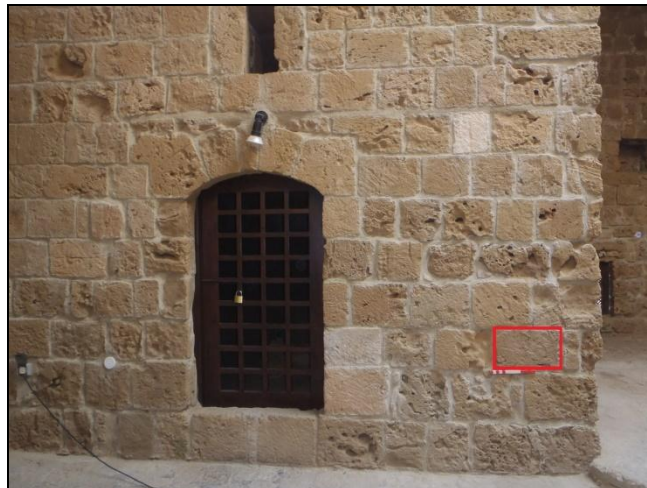
Εικ. 4.1.20α: Μακροσκοπική εικόνα ανατολικής εσωτερικής τοιχοποιίας, Θέση δείγματος 20.
