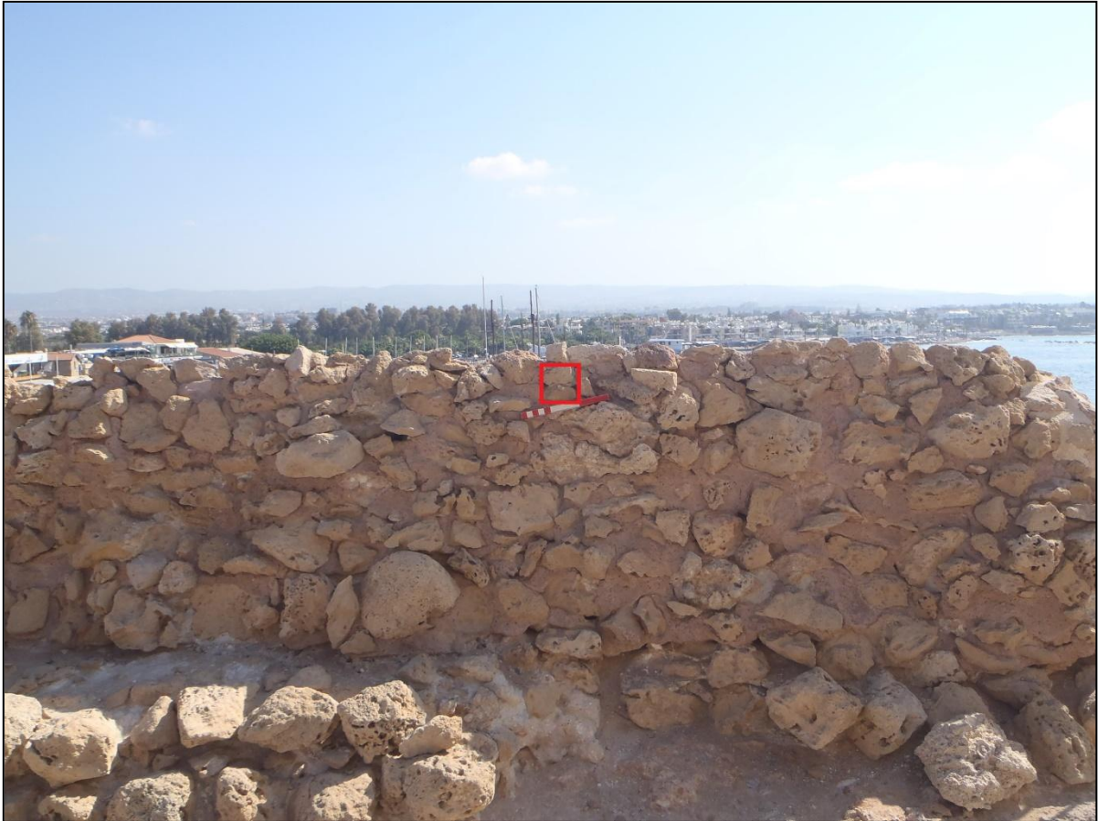
Εικ. 4.1.4α: Μακροσκοπική εικόνα τμήματος εξωτερικής ανατολικής τοιχοποιίας. Θέση δείγματος 4.
