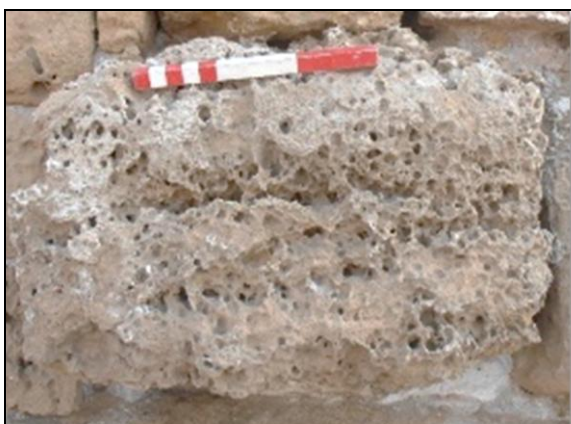
Εικόνα 5.2.5: Μηχανισμός φθοράς τύπου κυψελοειδής διάβρωση.
