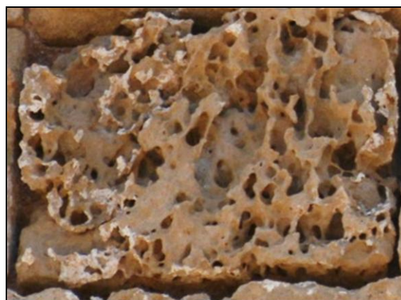
Εικόνα 5.2.6: Μηχανισμός φθοράς τύπου "κυψελοειδής διάβρωση".
