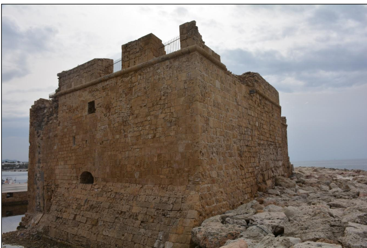
Εικ. 1.10. Νοτιοδυτική πλευρά κάστρου. Η παρουσία κυματοθραύστη προστατεύει το μνημείο από τον κυματισμό, ωστόσο τα φαινόμενα φθοράς από τη δράση της θάλασσας είναι εμφανή.
