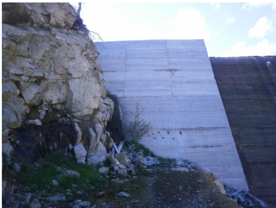
Εικόνα 8: Διαρροές στο Δυτικό αντέρεισμα του φράγματος
