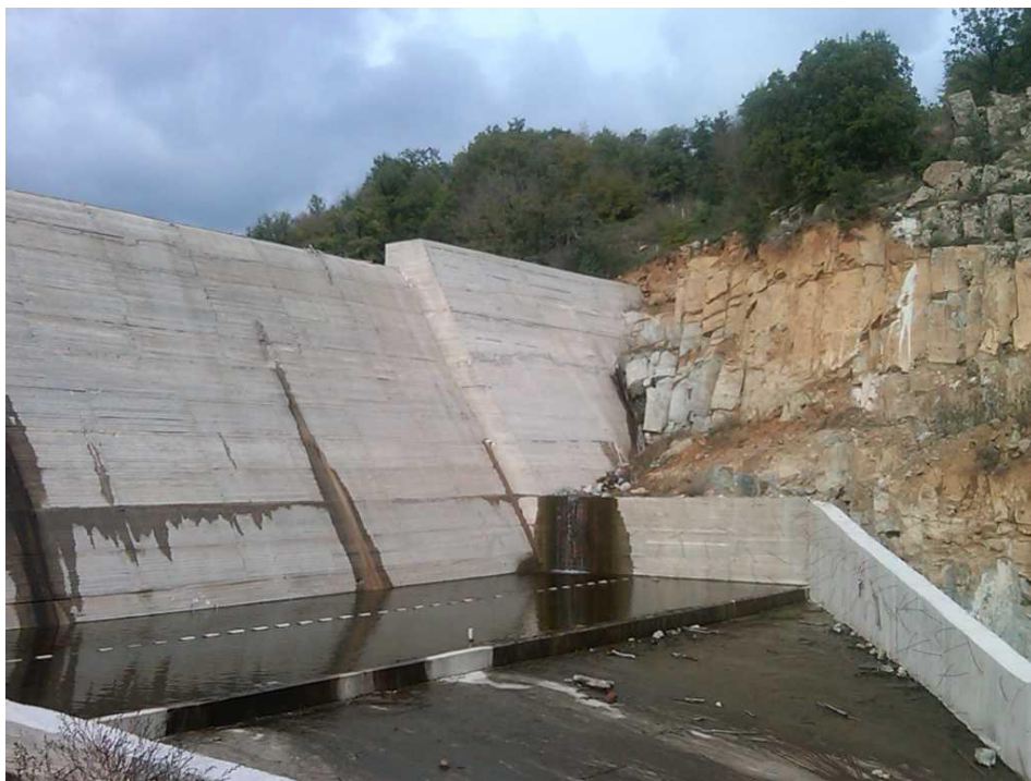
Εικόνα 5: Διαρροές στο Ανατολικό αντέρεισμα του φράγματος
