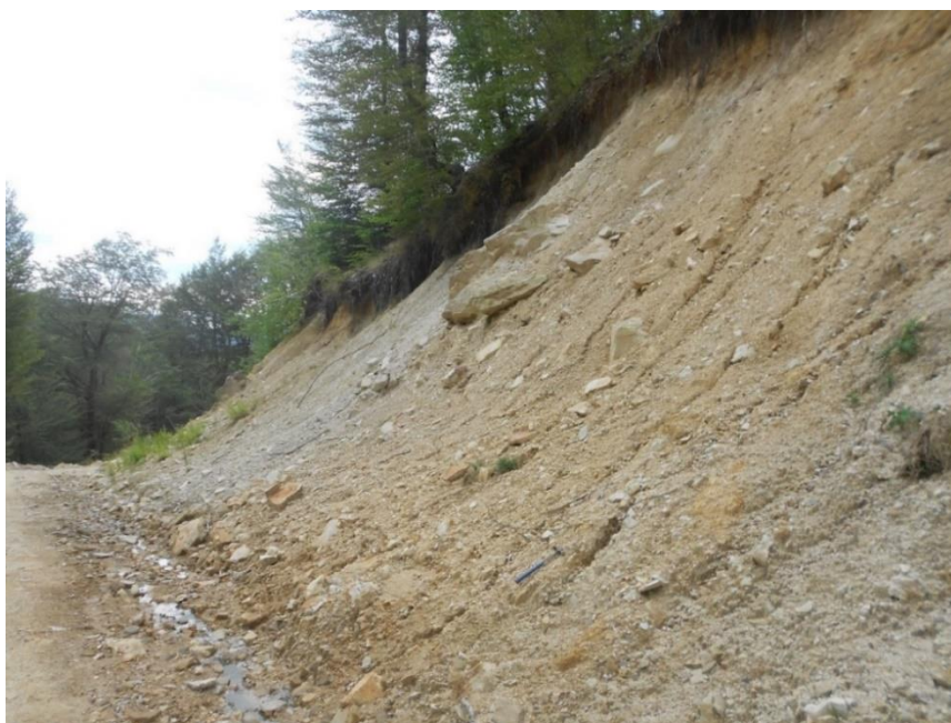
Εικόνα 3.5. Τα κατολισθέντα υλικά του πρανούς ενδιαφέροντος στη Χ.Θ. 12+640 του 4 ου τμήματος Μελίβοια-Σύνορα.
