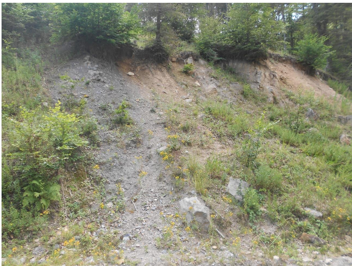
Εικόνα 2.12. Κατολισθέντα υλικά του 4 ου τμήματος Μελίβοια-Σύνορα.
