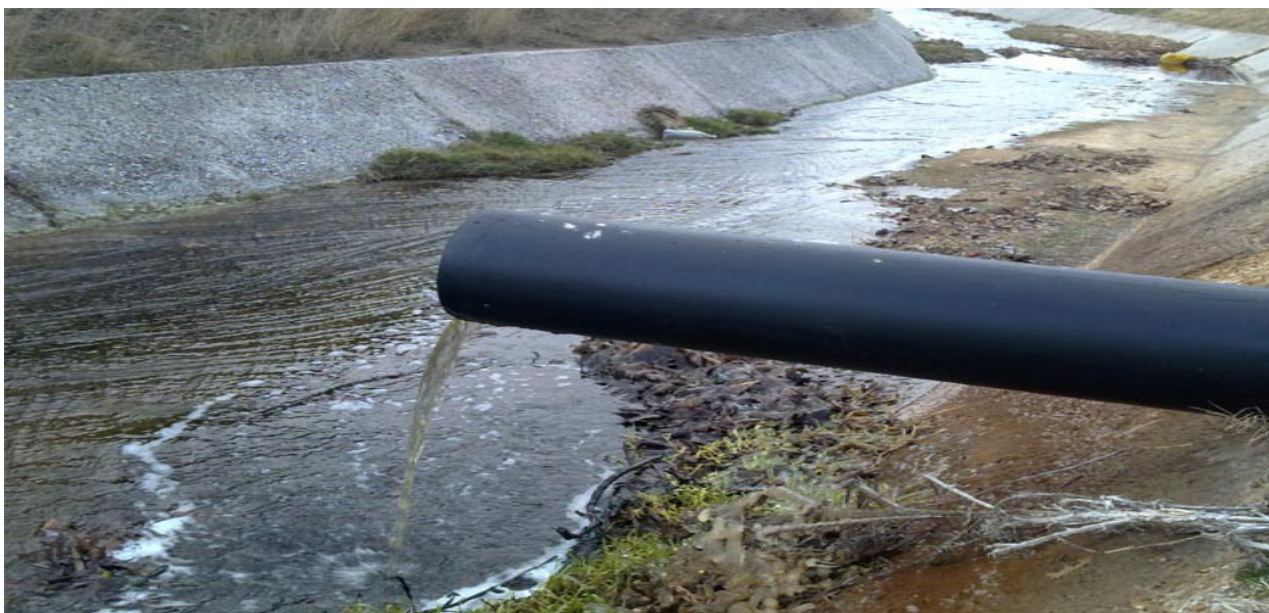
Εικόνα 6: Αγωγός εκφόρτισης διασταλαζόντων. ( Βαργεμέζης Γ. , Τσούρλος Π. , 2013 )
