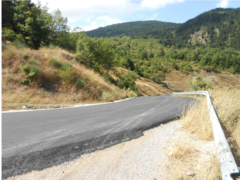
Φωτογραφία 1 Αποψη της κατολίσθησης από το σημείο σάρωσης. Στο βάθος και δεξιά φαίνονται αχνά τα σιρματοκιβώτια.
