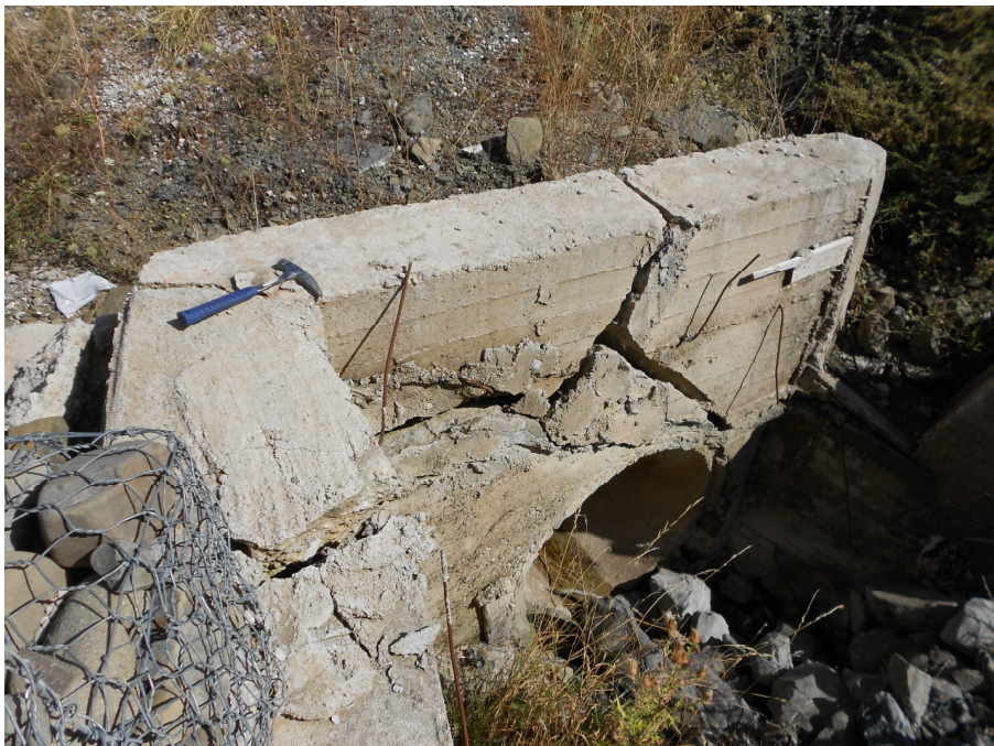
Φωτογραφία 8 Φαίνεται ο αγωγός για την ομαλή διέλευση του νερού μέσα από την μάζα της κατολίσθησης. Είναι εμφανής η καταστροφή του έργου λόγω των αναπτυσσόμενων τάσεων.
