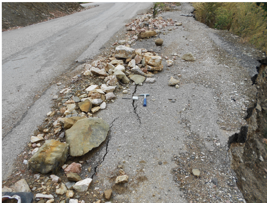
Φωτογραφία 12 Εφελκυστικές ρωγμές που υφίσταται ο δρόμος λόγω της κατολίσθησης στην θέση κατολίσθησης – Φιδάκια 1.
