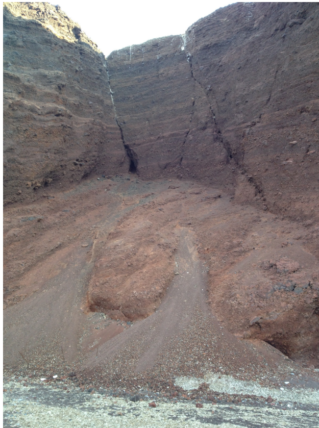
Φωτογραφία 23 Θέση από την οποία κατολίσθησε η μάζα σκωριών των Αύγουστο του 2013, όγκου 300 m 2 .
