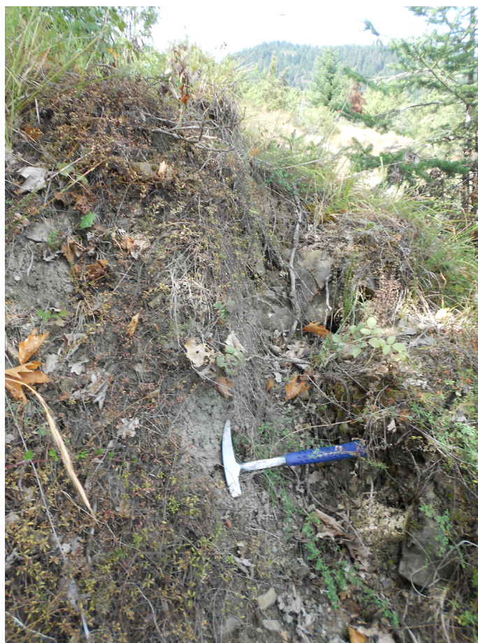
Φωτογραφία 5 Εφελκυστική ρωγμή στο έδαφος κατά πλάτος του ρέματος.
