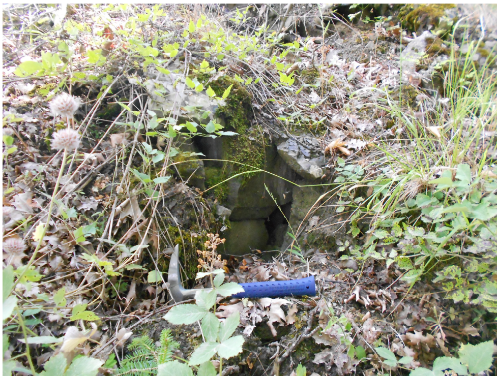
Φωτογραφία 6 Εφελκυστική ρωγμή στο έδαφος κατά πλάτος του ρέματος.
