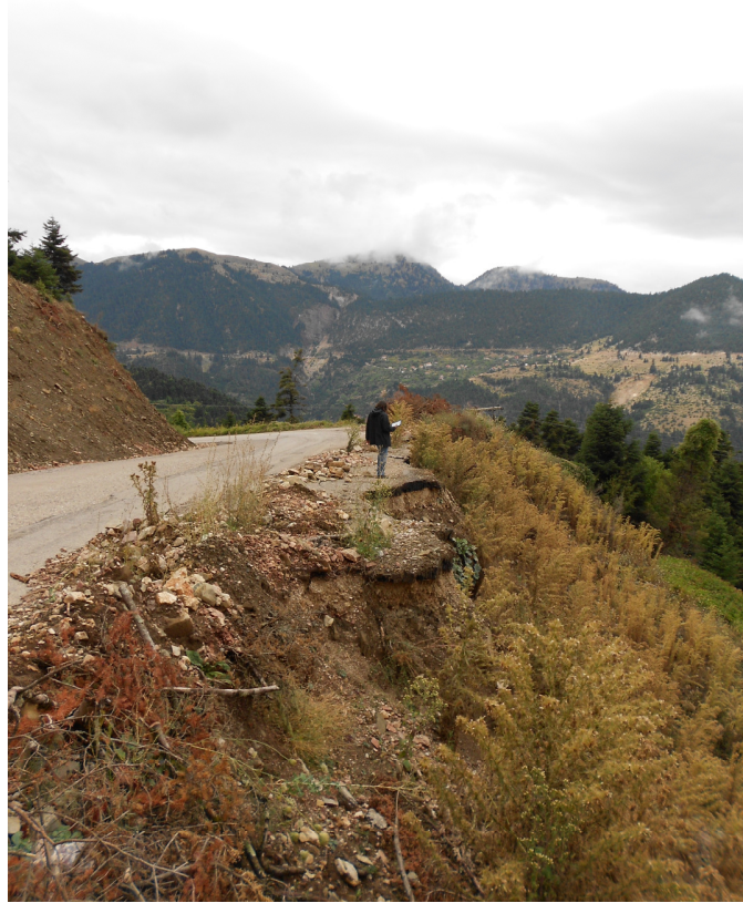
Φωτογραφία 11 Άποψη της καταστροφής που επιδέχεται ο δρόμος λόγω της κατολίσθησης στην θέση κατολίσθησης – Φιδάκια 1.
