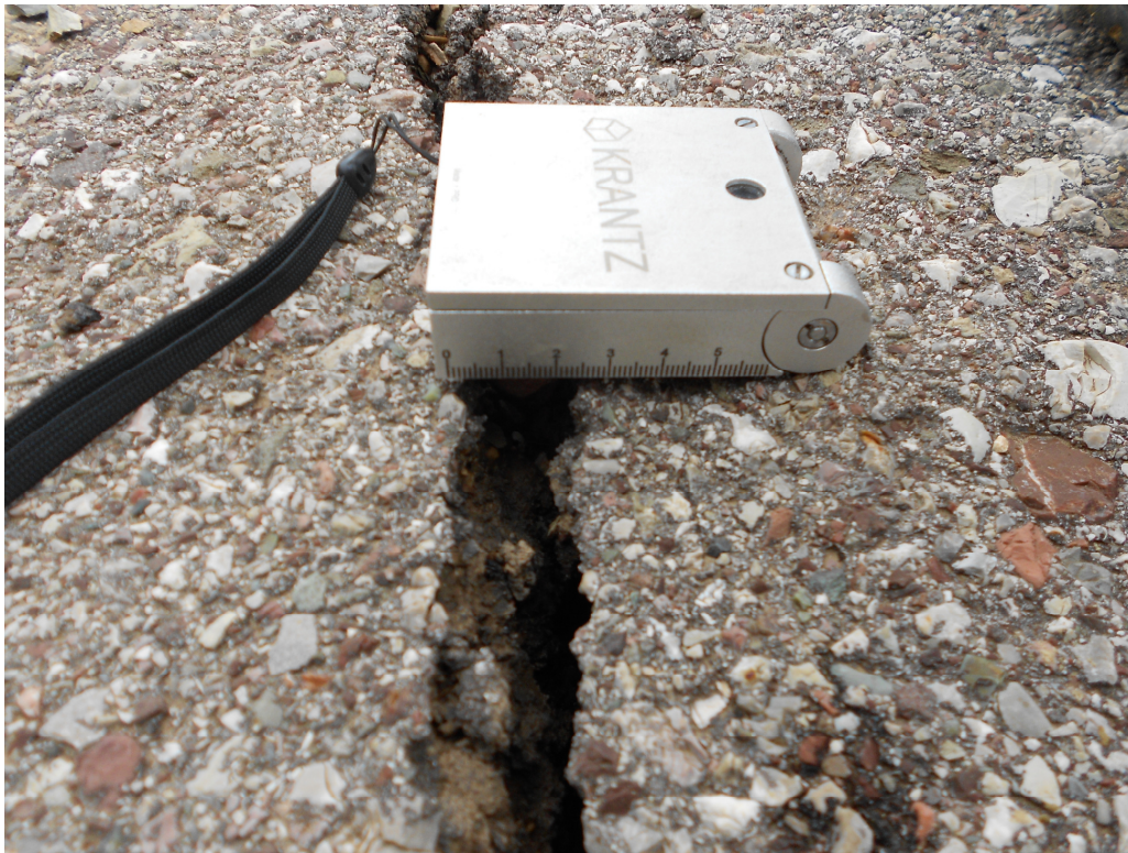
Φωτογραφία 13 Μέτρηση ανοίγματος εφελκυστικής ρωγμής στον δρόμο λόγω της κατολίσθησης στην θέση κατολίσθησης – Φιδάκια 1. Παρατηρούμε ότι το άνοιγμα είναι 2.5cm.
