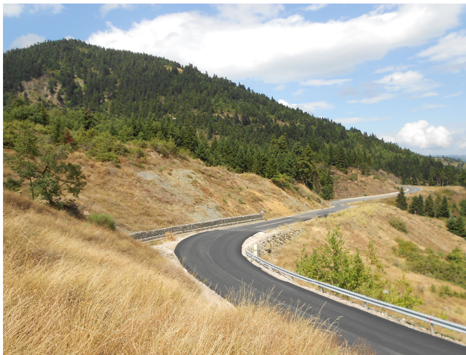
Φωτογραφία 2 Φαίνεται η θέση κατολίσθησης – Τυμφορηστός. Μπορούμε να παρατηρήσουμε ότι δρόμος είναι ασφαλτοστρωμένος ξανά ενώ στο βάθος φαίνονται τα σιρματοκιβώτια (ζαρζανετια) τα οποία συγκρατούν τα κορήματα της κατολίσθησης.
