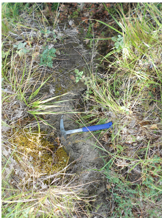
Φωτογραφία 4 Εφελκυστική ρωγμή στο έδαφος κατά πλάτος του ρέματος.
