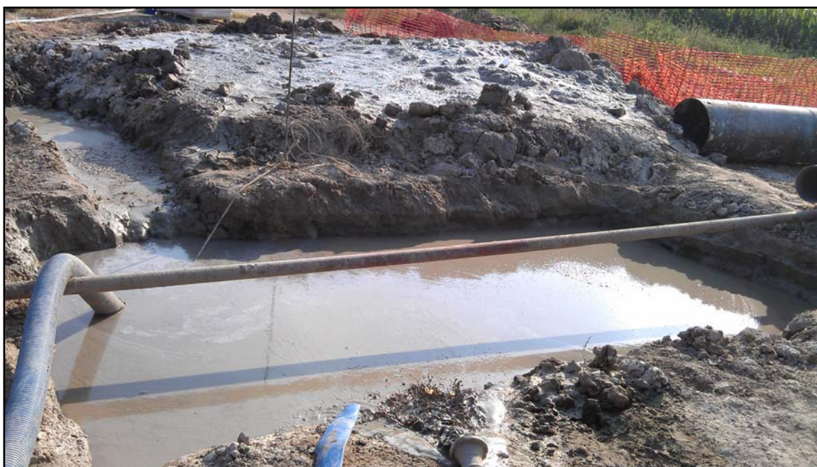
Εικόνα 1. Δεξαμενές πολφού διάτρησης στο χώρο της γεώτρησης.
