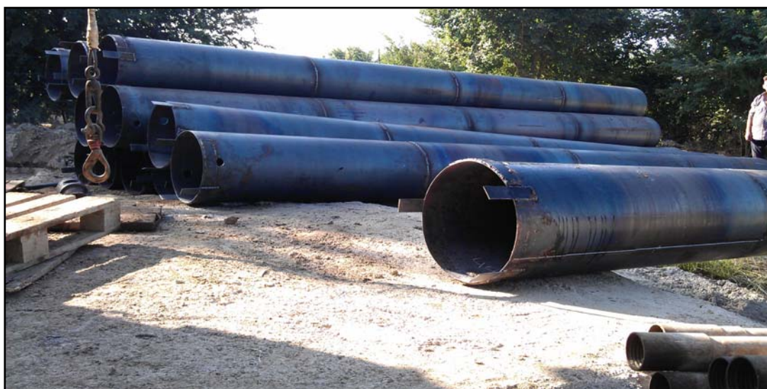
Εικόνα 7. Περιφραγματικοί σωλήνες με διάμετρο 17 ίντσες
