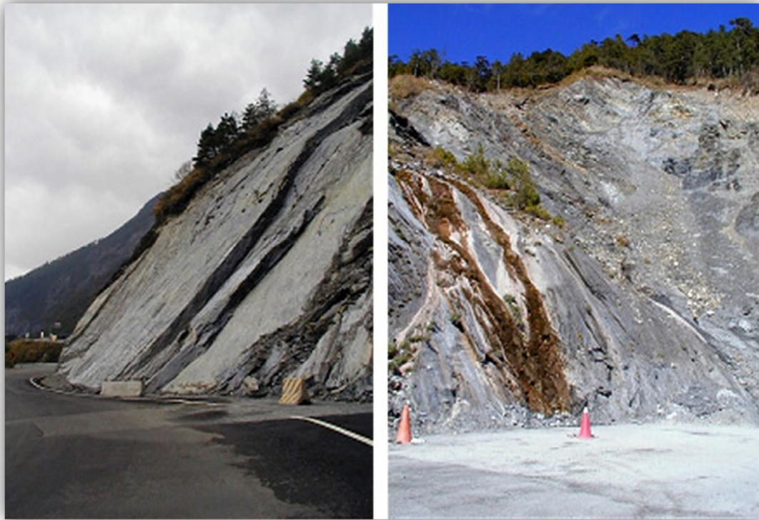
Εικόνα 4.11 : Φωτογραφίες που δείχνουν τις αστοχίες των πρανών στην περιοχή που μελετάται, Ya-Ching Liu, Chao-Shi Chen, 2007
