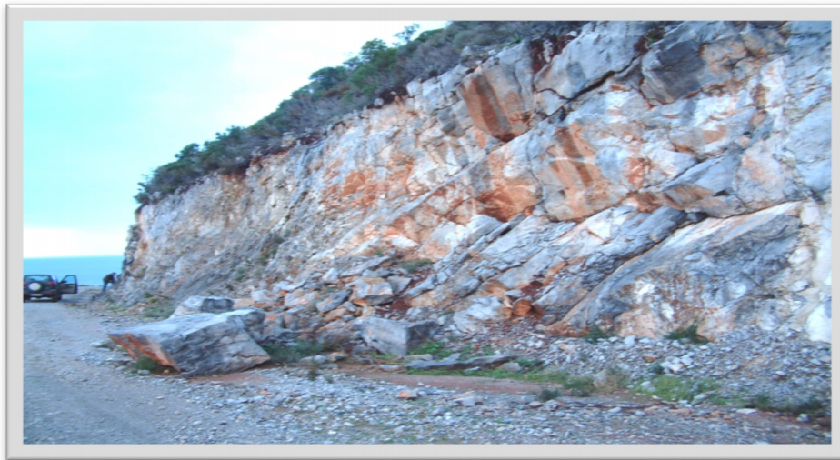
Εικόνα 3.1 : Αστοχία σφήνας και κατάπτωση σε ασβεστολιθική βραχώμαζα, [51]
