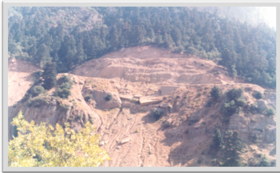
Εικόνα 3.8 : Αστοχία σε σχηματισμούς των νεογενών σε τμήμα του δρόμου Διακοφτού – Καλαβρύτων, [51]
