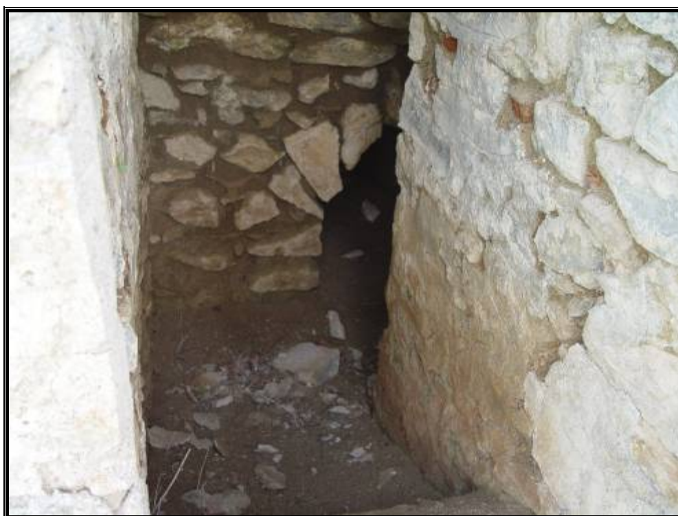
Φωτ. 3.1.1 Υπόγειο σύστημα συλλογής νερού στην περιοχή μελέτης (φωτογραφία: Β. Μέλφος).
