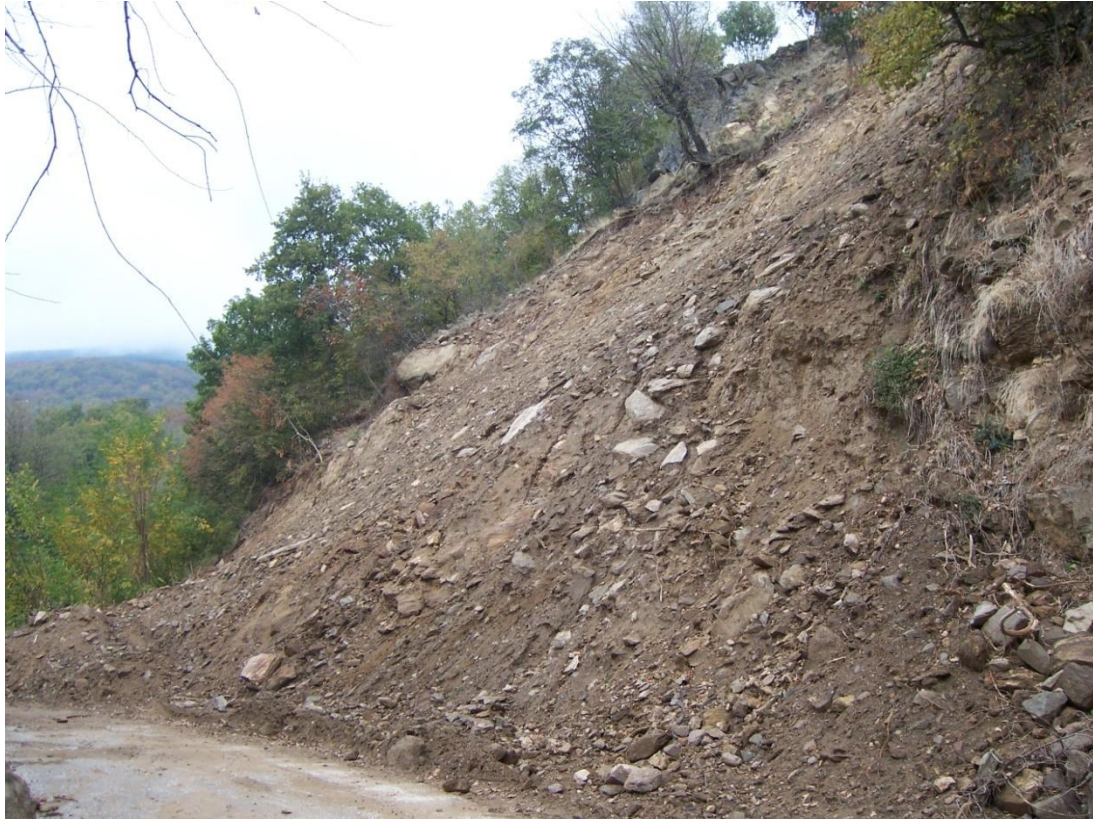
Φωτ.3: Το πρανές με τον όγκο του εδαφικού υλικού που εδράζεται επί του μαραμαρυγιακού σχιστόλιθου. (Λήψη φωτ.Νοέμβρης 2013).
