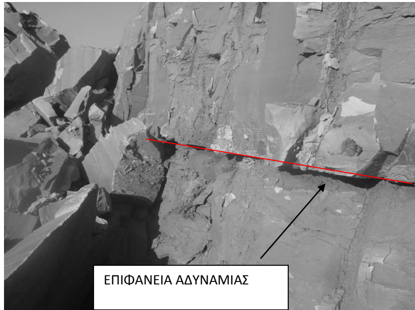
Σχήμα 4.5.10: Κοντινή όψη της επιφάνειας αδυναμίας πάνω στην οποία πραγματοποιείται η κύρια ολίσθηση, με το υλικό πλήρωσης, πολύ πτωχών μηχανικών χαρακτηριστικών, που διευκολύνει τις μετακινήσεις κατά μήκος της (Προυντζόπουλος et.al. 2010 )
