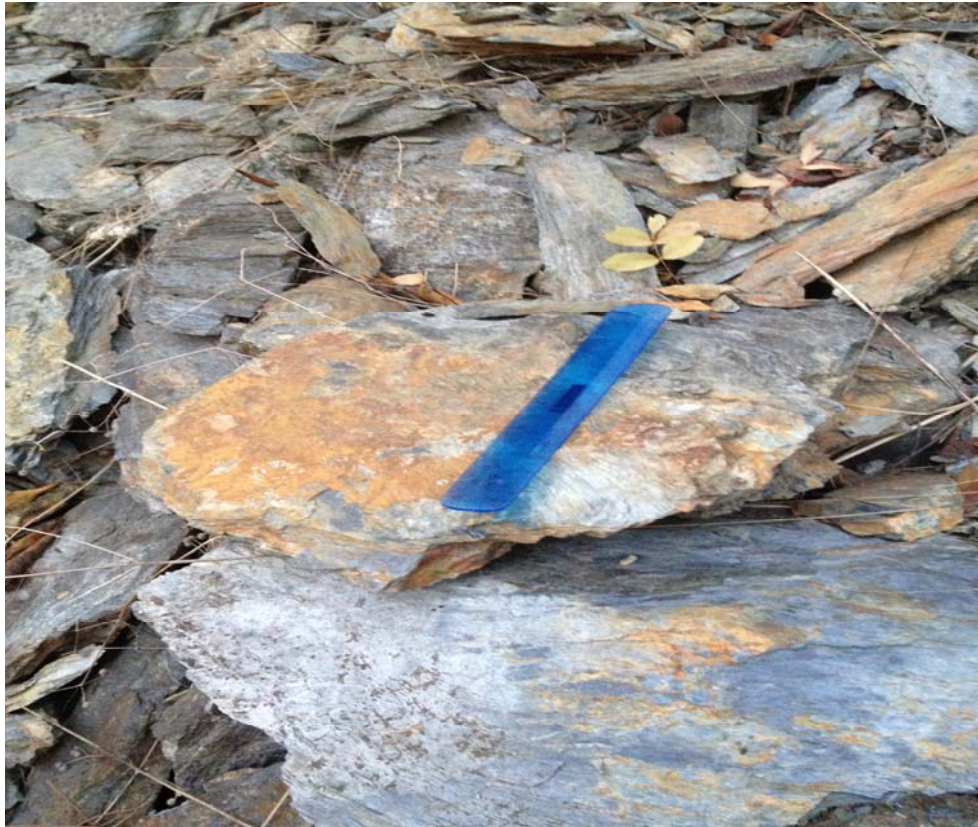
Εικόνα 4.10 Αποκόλληση τεμάχους – block στο πρανές, διακρίνεται με πορτοκαλί χρώμα (οξείδια Fe) η συμμετοχή της αποσάθρωσης στην αστοχία.
