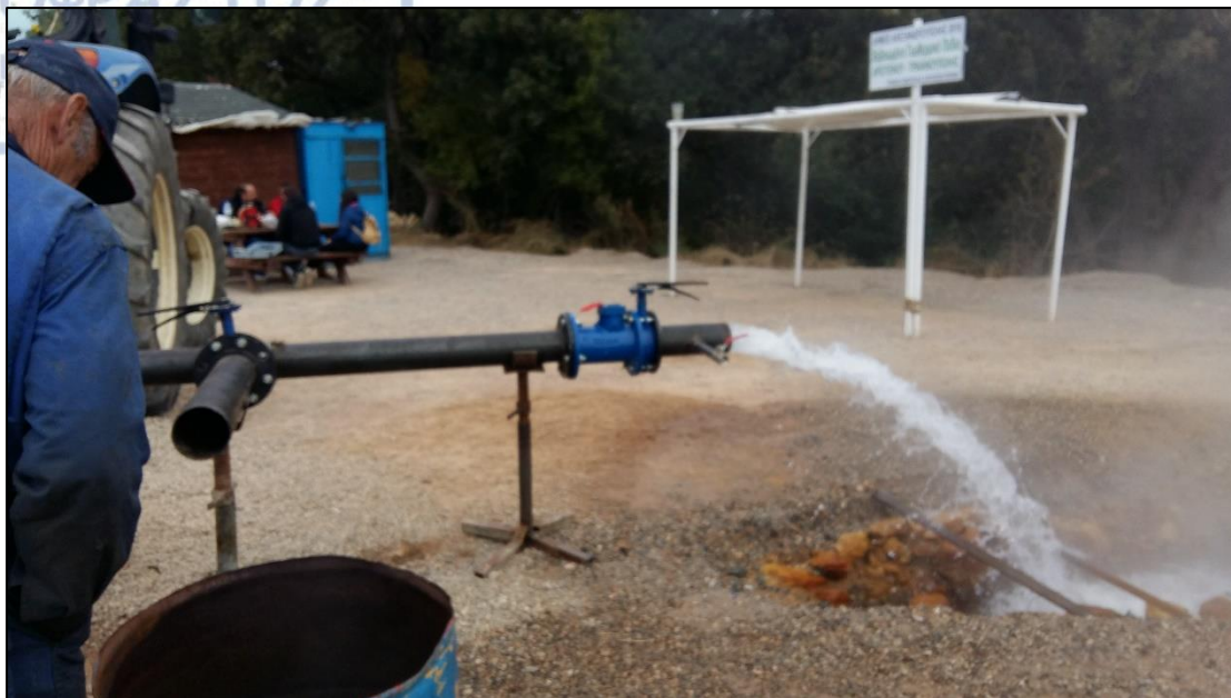
Σχήμα 30 – Διάταξη Σωλήνων στην έξοδο της κεφαλής της γεώτρησης (κάτω αριστερά διακρίνεται η μεταλλική δεξαμενή χωρητικότητας 250lt)
