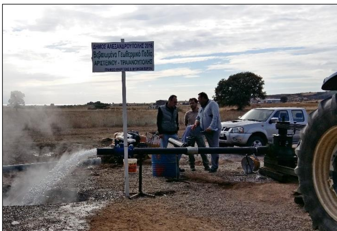
Σχήμα 29 - Αντληση Σταθερής Παροχής (στο κέντρο διακρίνεται η διάταξη στην έξοδο της κεφαλής της γεώτρησης)
