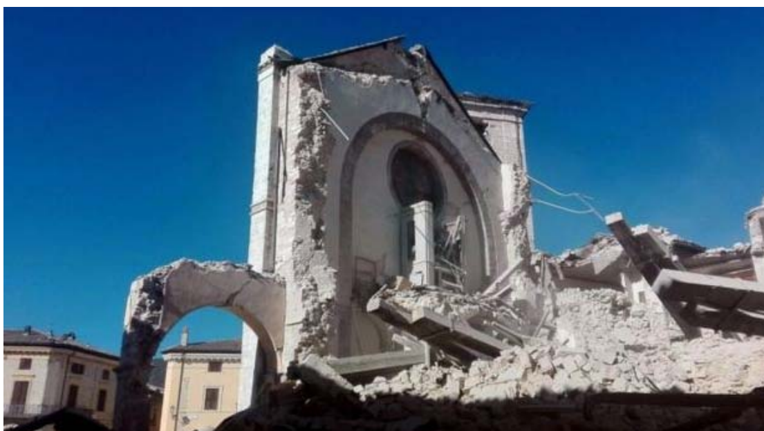
Σχήμα 2.8. Το εσωτερικό της βασιλικής εκκλησίας του Αγίου Βενέδικτου στη Νορκία, μετά το σεισμό του Οκτωβρίου 2016 ( http://www.bbc.co.uk/news/av/world-europe-37821998/italy-quake-drone-footage-shows-norcia-basilica-damage ).
