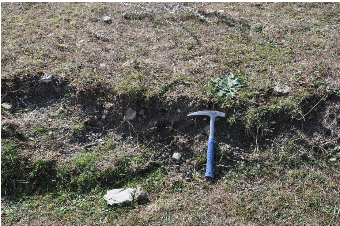
Εικόνα 7.19 Η ίδια διάρρηξη όπως αποτυπώθηκε τον Σεπτέμβριο 2017. Έντονο σημάδι ενεργότητας της κατολίσθησης.
