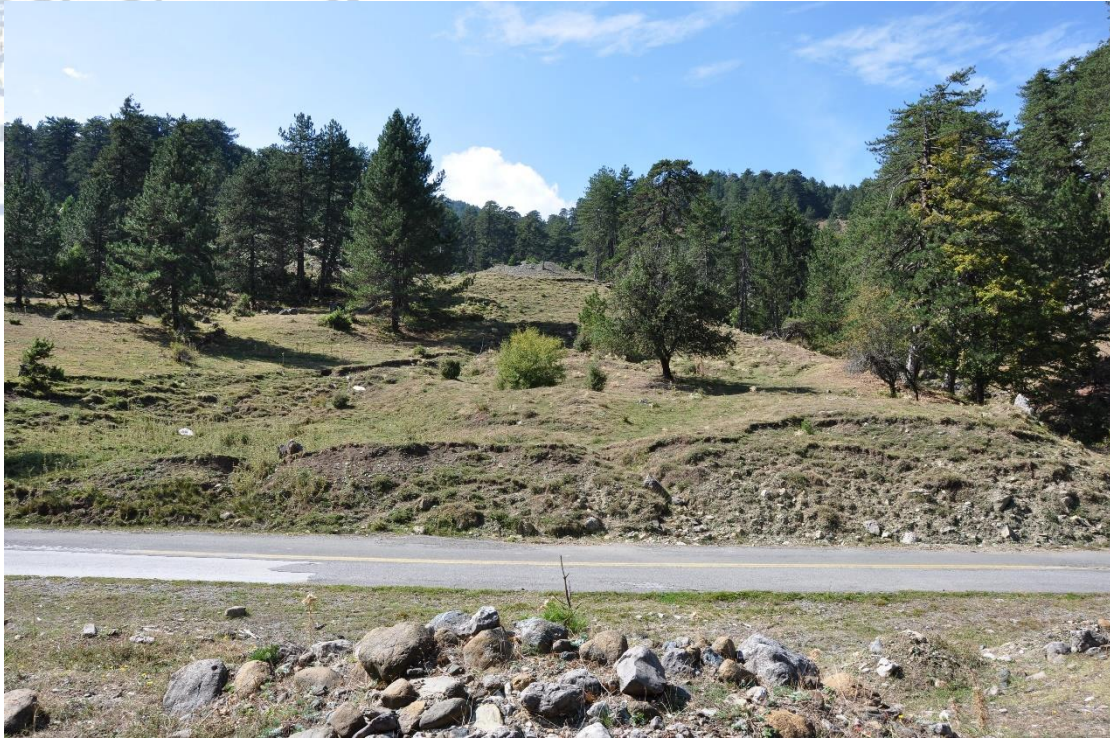
Εικόνα 7.25 Η κατολίσθηση Ls_Per7 αποτυπωμένη από τα κατάντη. Παρατηρούνται οι εξάρσεις του αναγλύφου και η επιρροή της στο σώμα του δρόμου.
