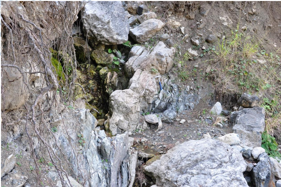
Εικόνα 7.14 Κατακόρυφη διάταξη των στρωμάτων του ασβεστόλιθου όπως αυτοί εντοπίστηκαν μέσα σε ρέμα.
