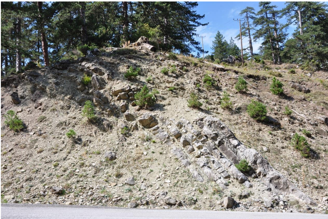
Εικόνα 7.13 Οι παρακατακόρυφα διατεταγμένοι ασβεστολιθικοί πάγκοι, εντοπίζονται σε σταθερή ράχη. Δεξιά αυτών εντοπίζεται η κατολίσθηση Ls_Per2 ενώ αριστερά υπάρχει ρέμα.
