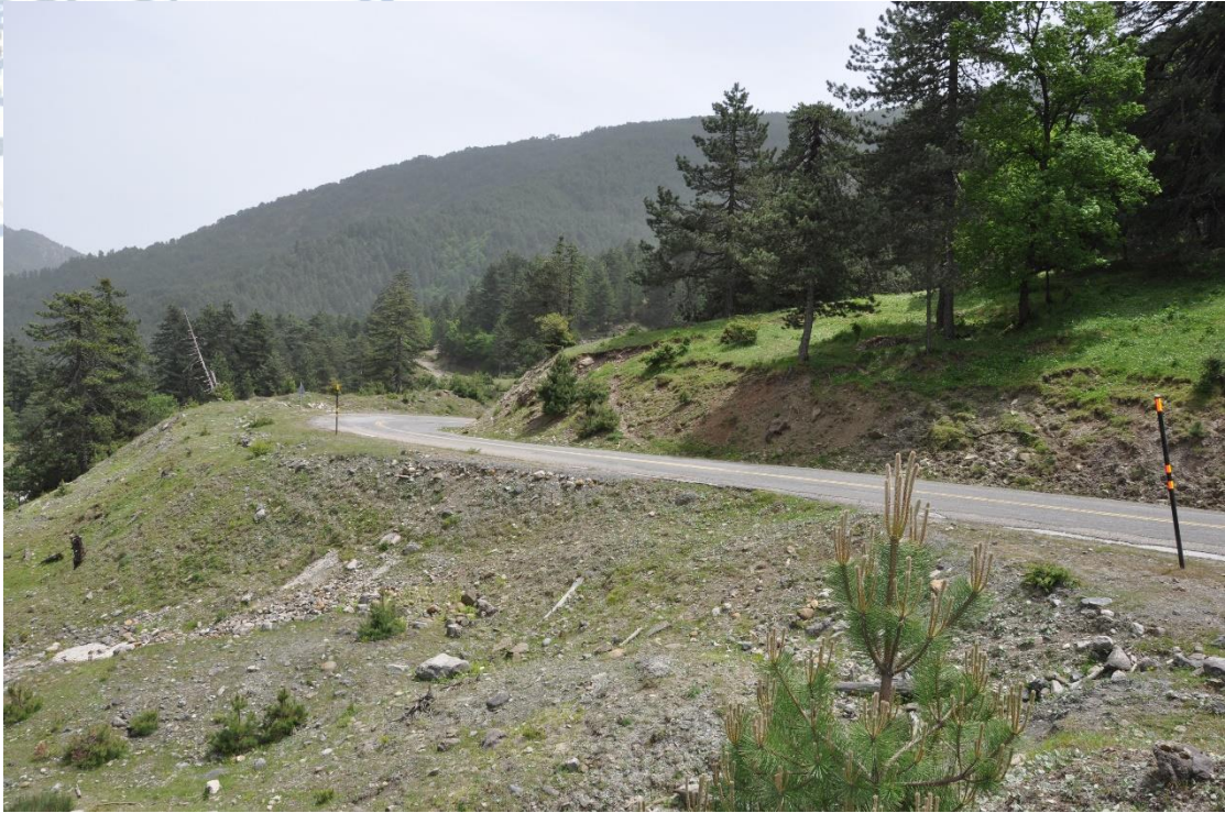
Εικόνα 8.3 Το φρύδι της κατολίσθησης όπως αυτό φαίνεται στην ύπαιθρο.
