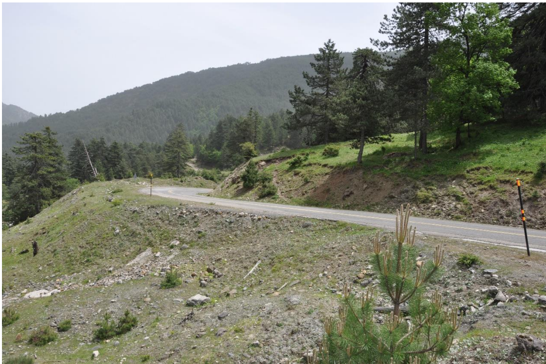
Εικόνα 7.26 Το φρύδι της ολίσθησης έχει επηρεάσει και τον δρόμο στα ανάντη, έχει φύγει τμήμα του.
