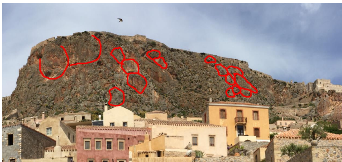
Εικόνα 5.25. Μεγάλα επισφαλή τεμάχια στο πρανές 4
