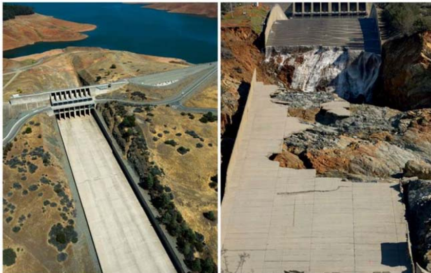
Φωτ. 2-14: Καταστροφή του εκχειλιστή από υπερπήδηση νερού του ταμιευτήρα σε παράπλευρο του εκχειλιστή σημείο, το οποίο προοριζόταν για δεύτερος εκχειλιστής έκτακτης ανάγκης στο Oroville dam ( www.SFGATE.com 2/3/17)
