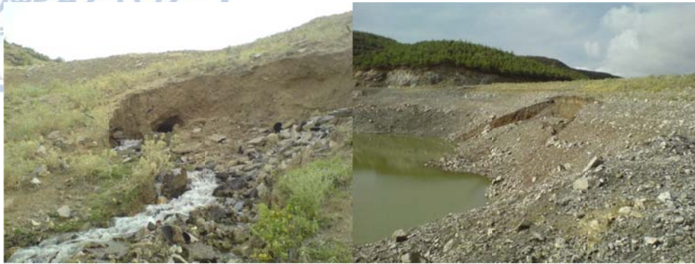
Φωτ. 2-5: Αστοχία ομογενούς φράγματος Τριαδίου, με απουσία στραγγιστικού στοιχείου λόγω εσωτερικής διάβρωσης στην κατόντη παρειά ενώ στην ανάντη παρειά του συνέβη ολίσθηση λόγω της γρήγορης πτώσης της στάθμης του ταμιευτήρα μετά την διαφυγή του νερού.
