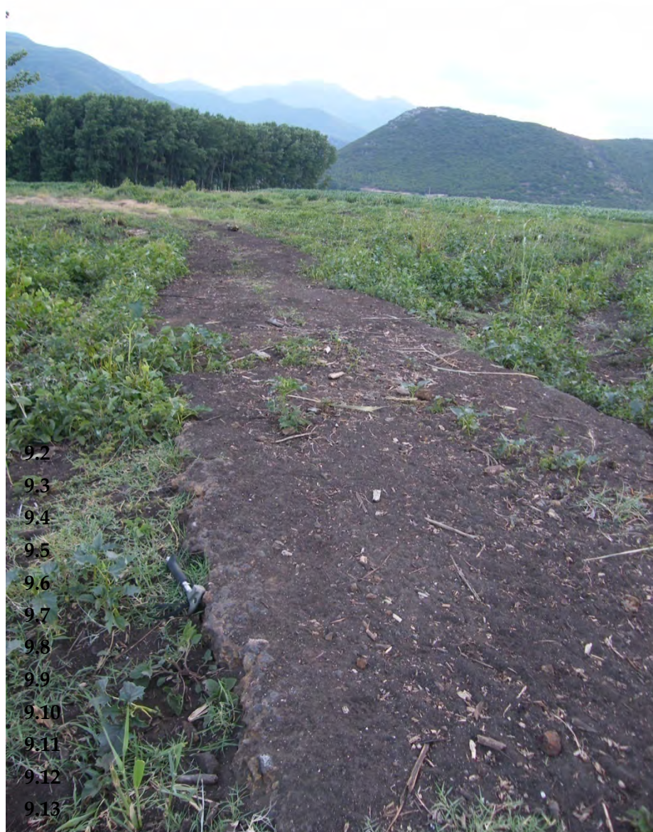
Εικόνα 9.1.3.1 Άποψη του δρόμου με τις σκωρίες.
