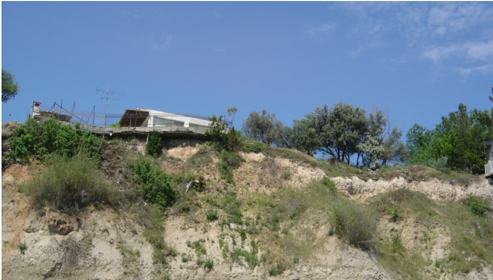
Εικόνα 13: Αυλή σπιτιού που πέφτει λόγω διάβρωσης
