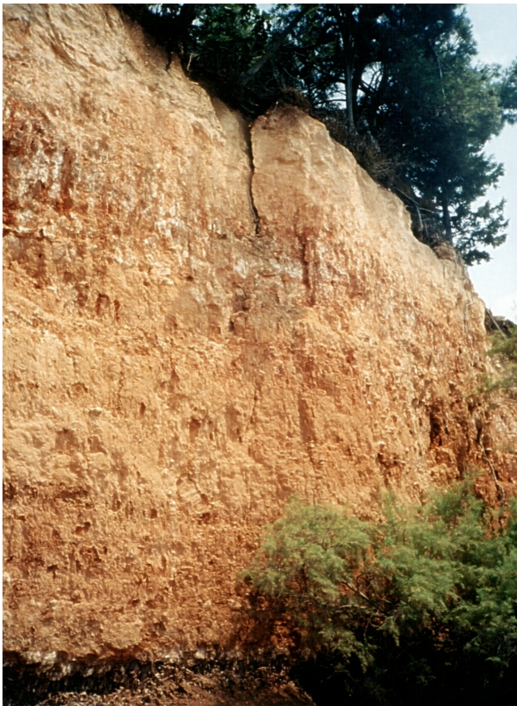
Εικόνα 11: Περιοχή όπου διακρίνεται η διάβρωση
