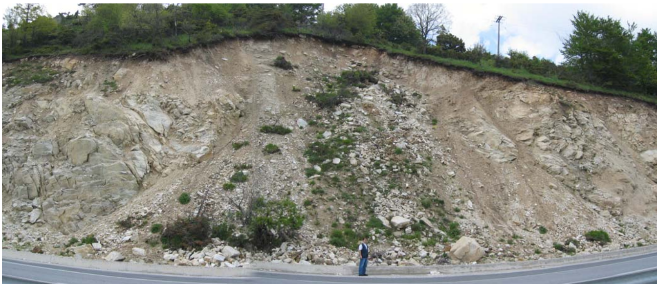
Φωτ. 13 Κατολίσθηση στην ασταθή ζώνη που χαρτογραφήθηκε στον ορθογενεύσιο (χάρτης 3).
