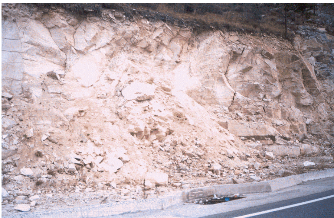
Φωτ. 14 Μικροί κώνοι κορημάτων από καταπτώσεις βράχων στην ασταθή ζώνη που χαρτογραφήθηκε στον ορθογενεύσιο (χάρτης 3).
