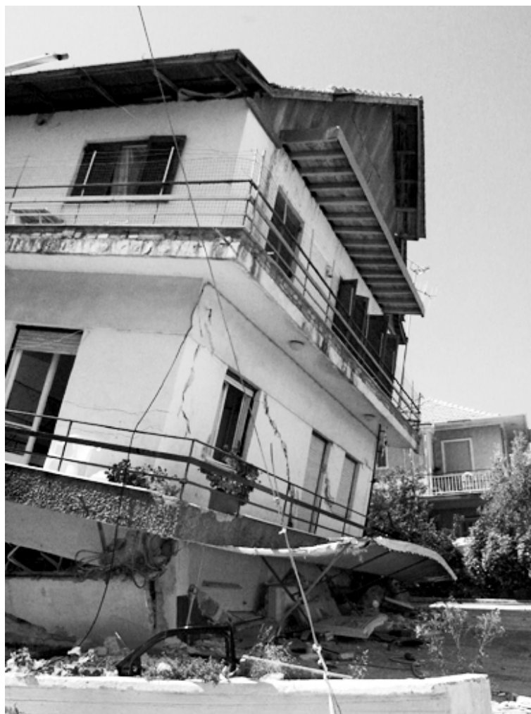
Σχήμα 1.7 – Εικόνα από ζημιές λόγω σεισμού στη Λευκάδα
