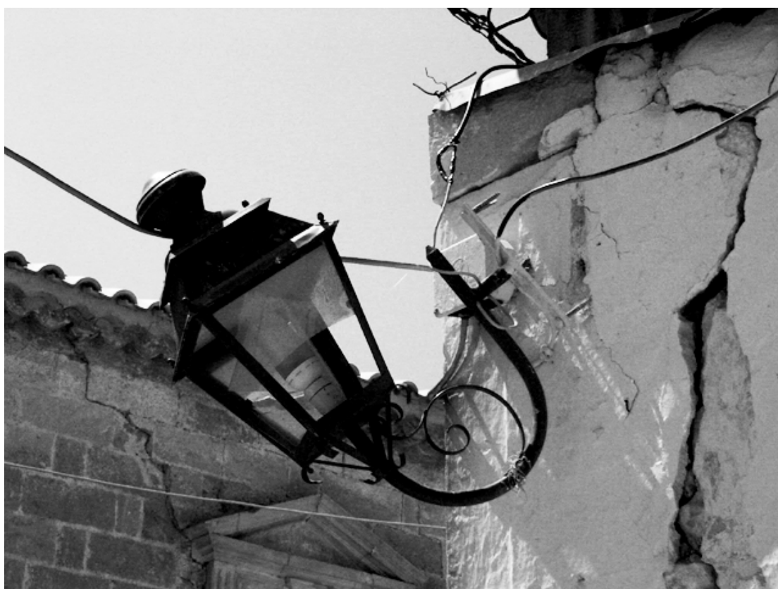
Σχήμα 1.5 – Εικόνα από ζημιές λόγω σεισμού στη Λευκάδα.
