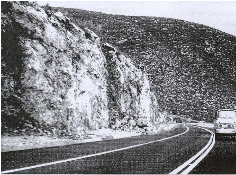
Εικόνα 8. Καταπτώσεις βραχωδών όγκων στην εθνική οδό.
