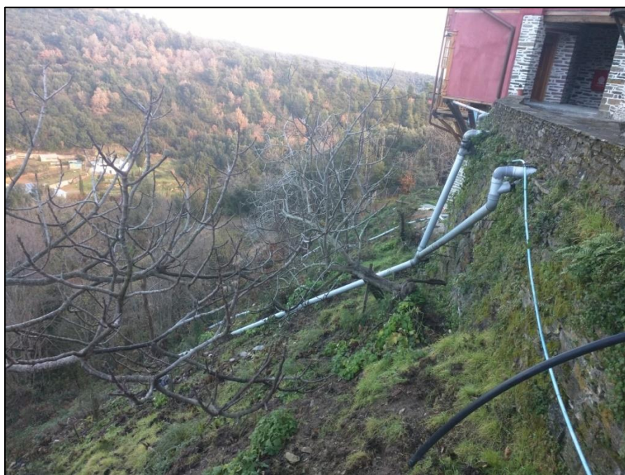
Εικόνα 9. Σωλήνες διευθέτησης όμβριων υδάτων.
