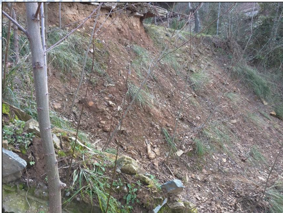
Εικόνα 49. Εικόνα υποσκαφής κάτω από το δρόμο εισόδου στη θέση παρατήρησης 14
