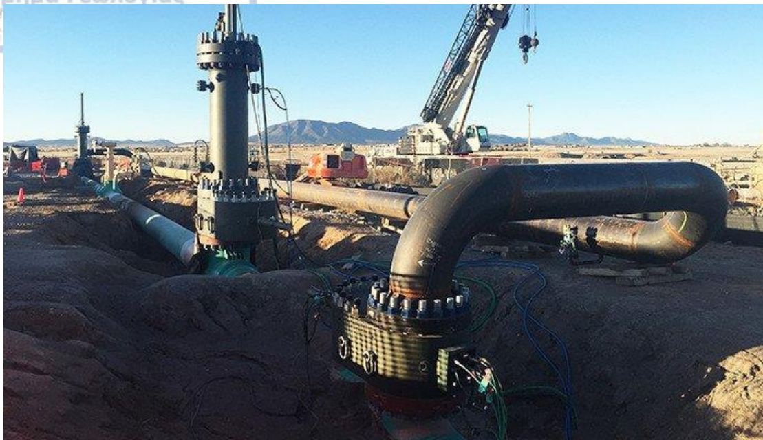
Εικόνα 4.1 : Αγωγοί μεταφοράς CO 2 ( https://www.linkedin.com/pulse/world-first-high-pressure-hot-tap-plugging-co2-pipelines-stats-group )
