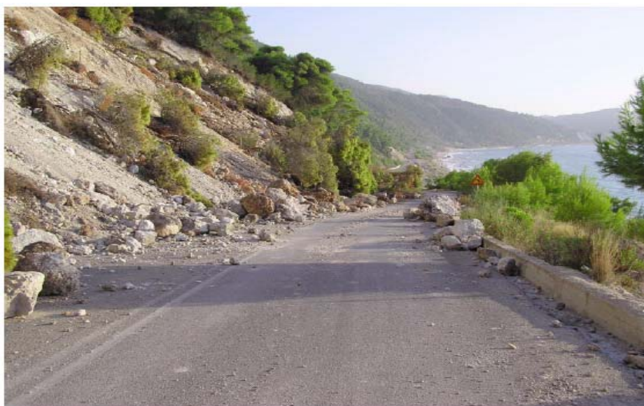
Σχήμα 5.4. Κατολίσθηση στα Πευκούλια.
