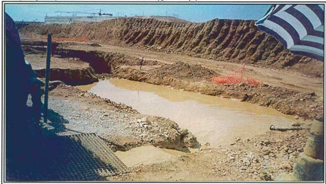
Εικόνα 11. Δεξαμενές καθίζησης και κυκλοφορίας του πολτού
