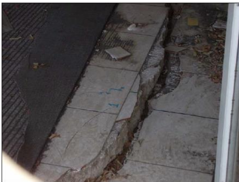
Σχήμα 4.7 Κτίριο στην οδό Κύπρου, με ρωγμή κατά μήκος του κτιρίου και ανύψωση του δαπέδου κατά 10 cm (Ζερβοπούλου, 2010).
