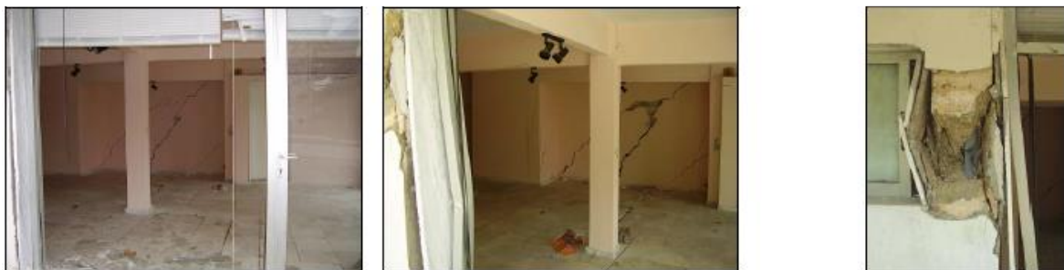
Σχήμα 4.5 Κτίριο στην οδού Αγνώστου Στρατιώτη, διακρίνονται οι ρωγμές στην τοιχοποιία (Ζερβοπούλου, 2010).
