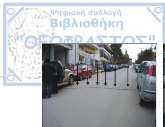
Σχήμα 4.6 Ρωγμές στο οδόστρωμα, το πεζοδρόμιο και σε περίφραξη στην οδό Μεγάλου Αλεξάνδρου (Ζερβοπούλου, 2010).
