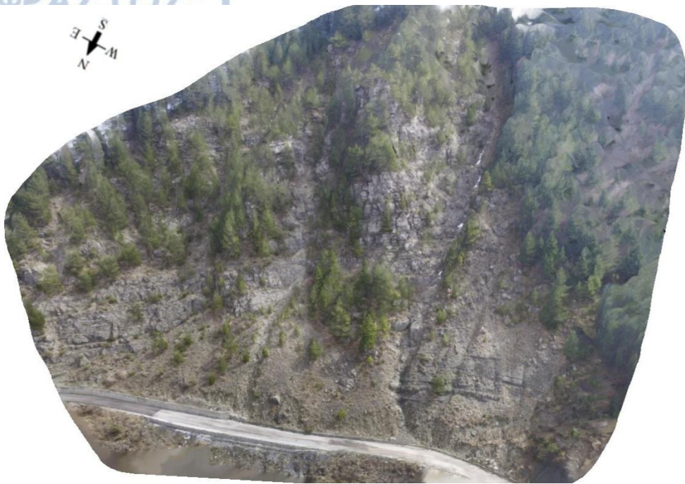
Εικόνα 5. 47 Ορθομωσαϊκό του πρανούς στο ανώτερο τμήμα της κατολίσθησης όπου παρατηρούνται καταπτώσεις βράχων.
