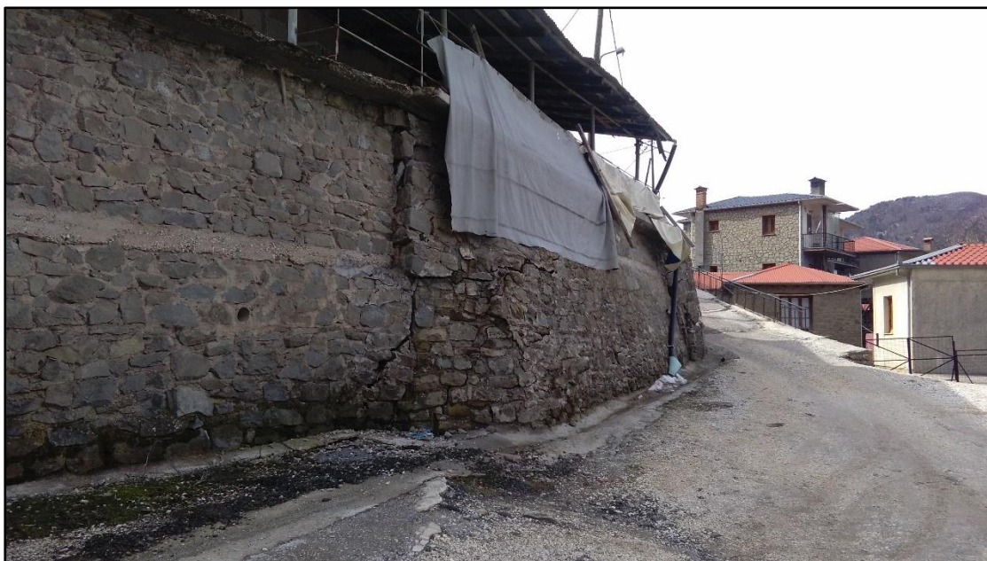
Εικόνα 5. 29 Ρωγμές σε οικία σημάδι κατολίσθησης (φωτογραφία από τον συγγραφέα).
