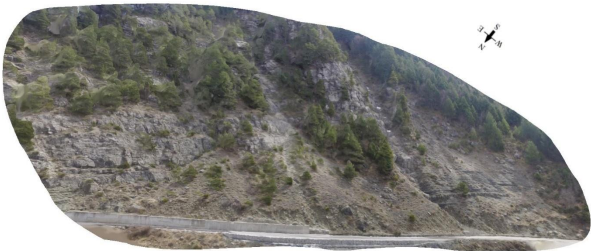
Εικόνα 5. 48 Ορθομωσαϊκό από άλλη γωνία, του πρανούς στο ανώτερο τμήμα της κατολίσθησης όπου παρατηρούνται καταπτώσεις βράχων.
