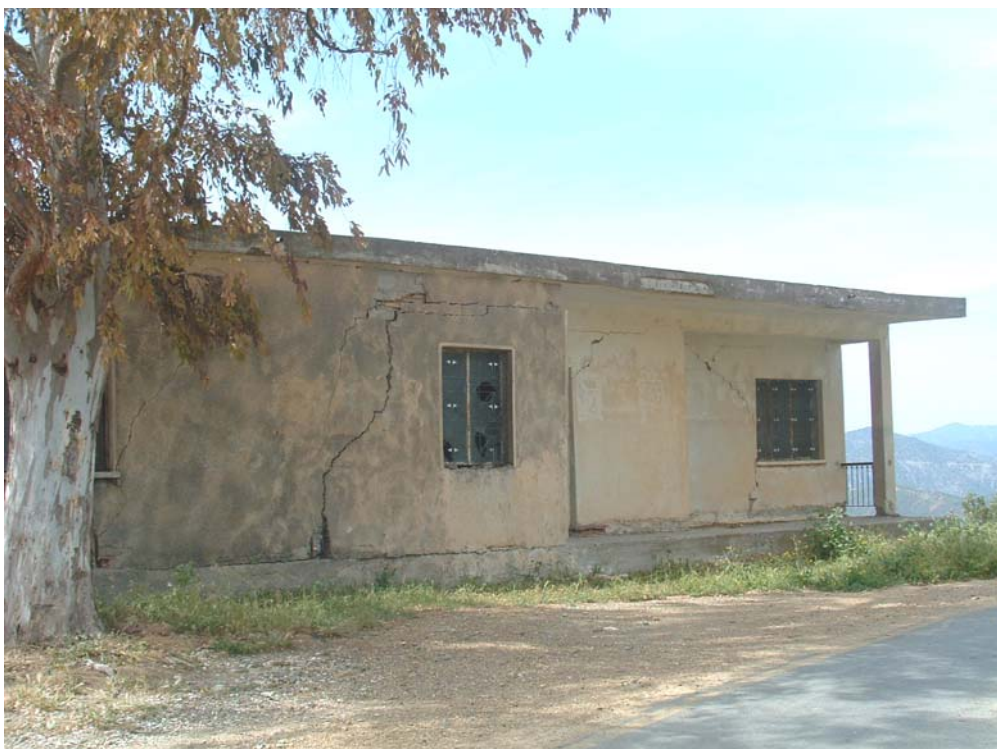
Φωτογραφίες 1&2. Ρωγμές και διαρρήξεις που έχουν δημιουργηθεί στον οικισμό Στατού μετά από κατολισθητικά επεισόδια.
