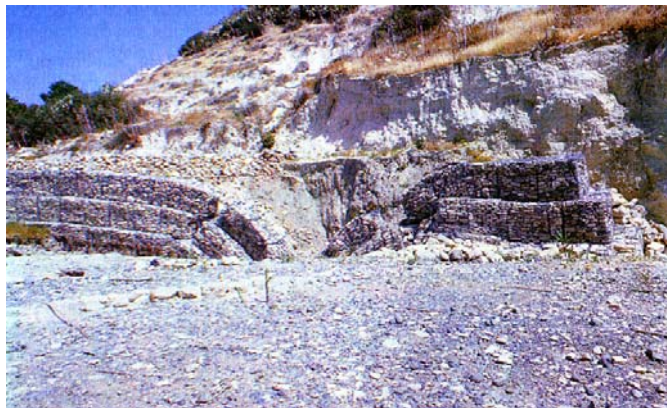
Εικόνα 17. Υποχώρηση τοίχου κατασκευασμένου από συρματοκιβώτια λόγω ύπαρξης υπόγειου εγκοίλου.
