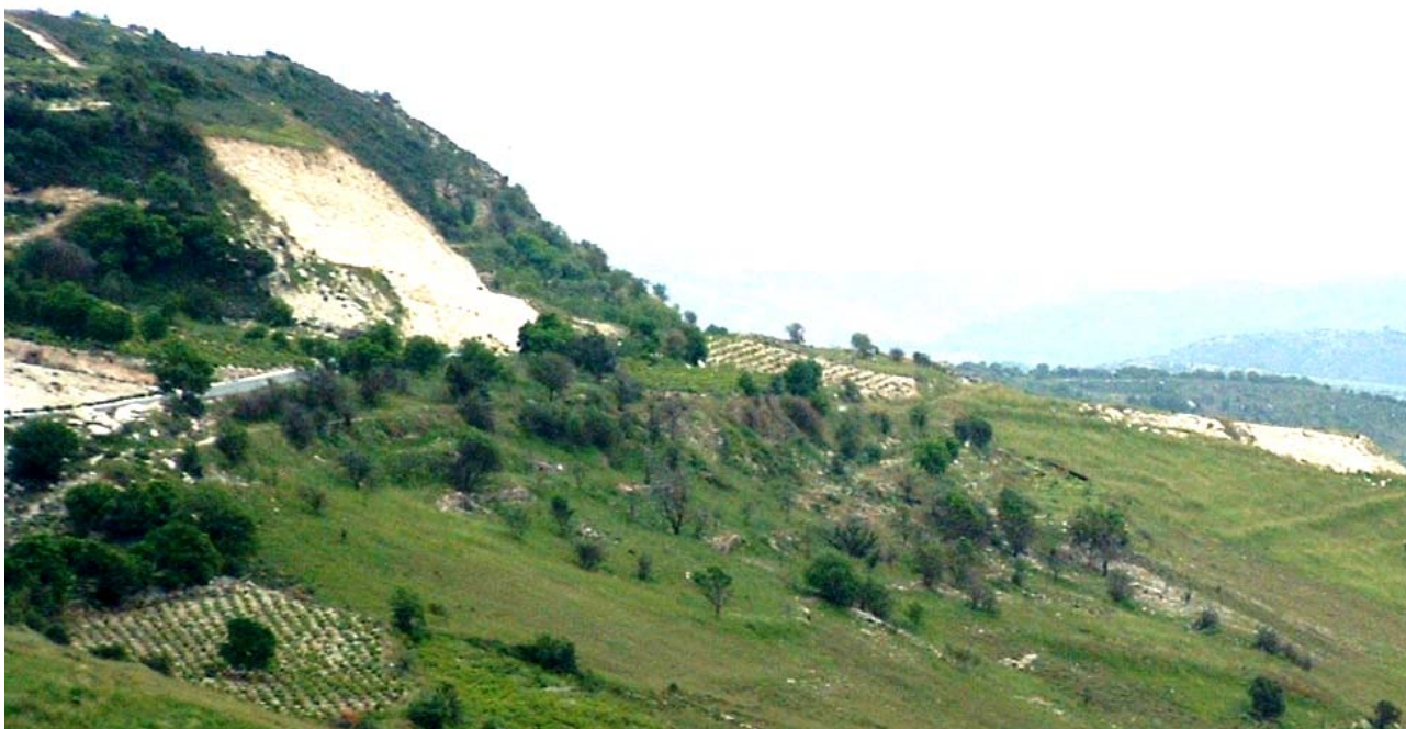
Φωτογραφία 7. Γενική άποψη του δρόμου μεταξύ των χωριών Πενταλιά και Στατός – Άγιος Φώτιος, στην οποία φαίνεται και η κλιτύς (πρανές) στην οποία εμφανίσθηκε η κατολίσθηση.
