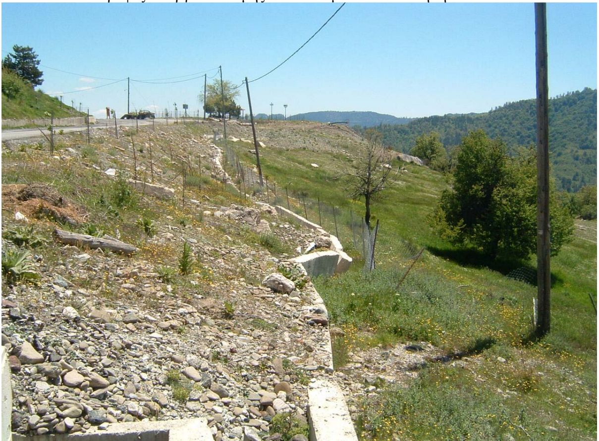
Φωτο 9: Καταστροφές σε έργα υποδομής του Οικισμού μετατόπιση του τοιχείου αντιστήριξης στην Κατολίσθηση Β.
