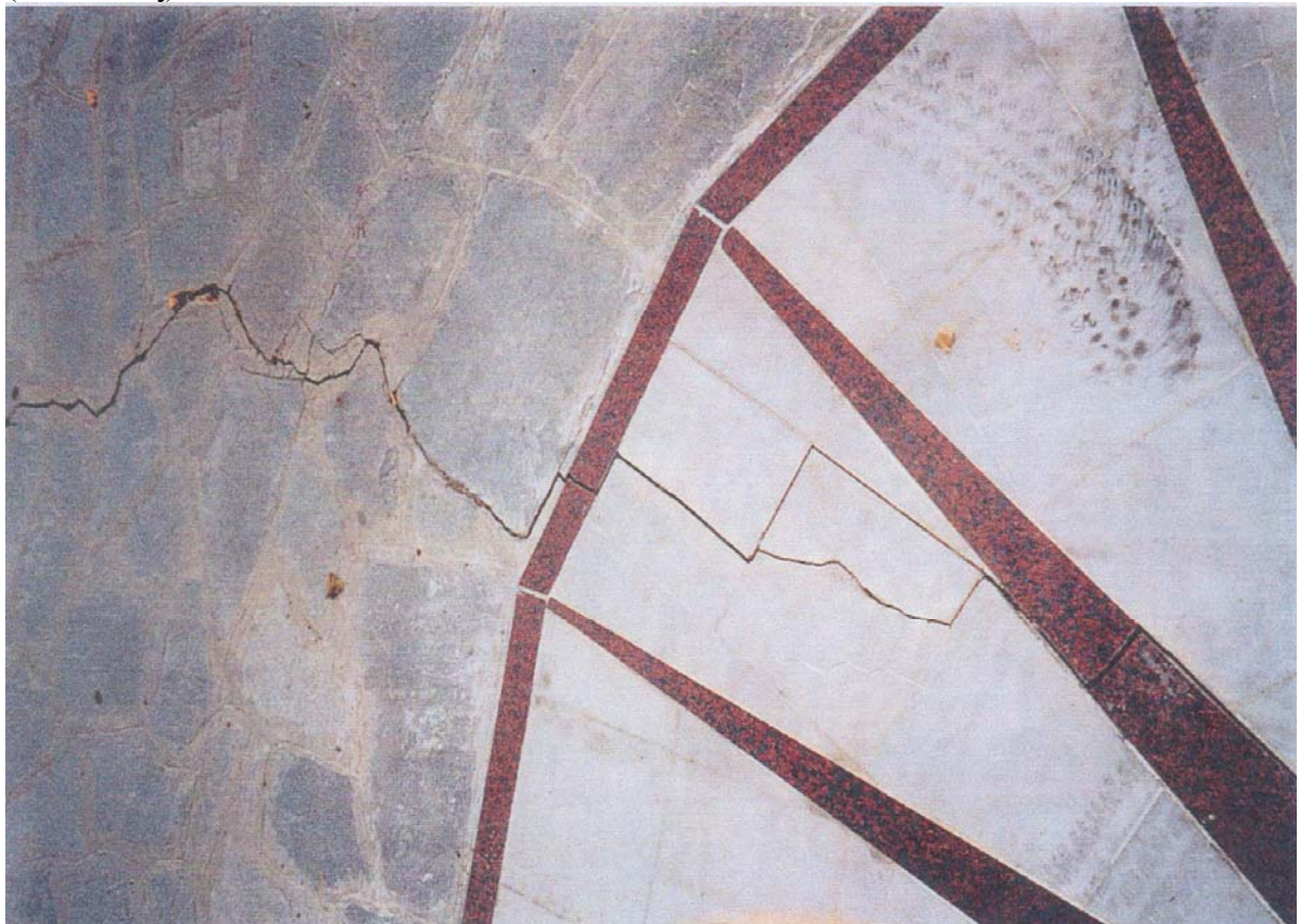
Φωτο 11: Ρωγμή στην πλατεία του Οικισμού.
