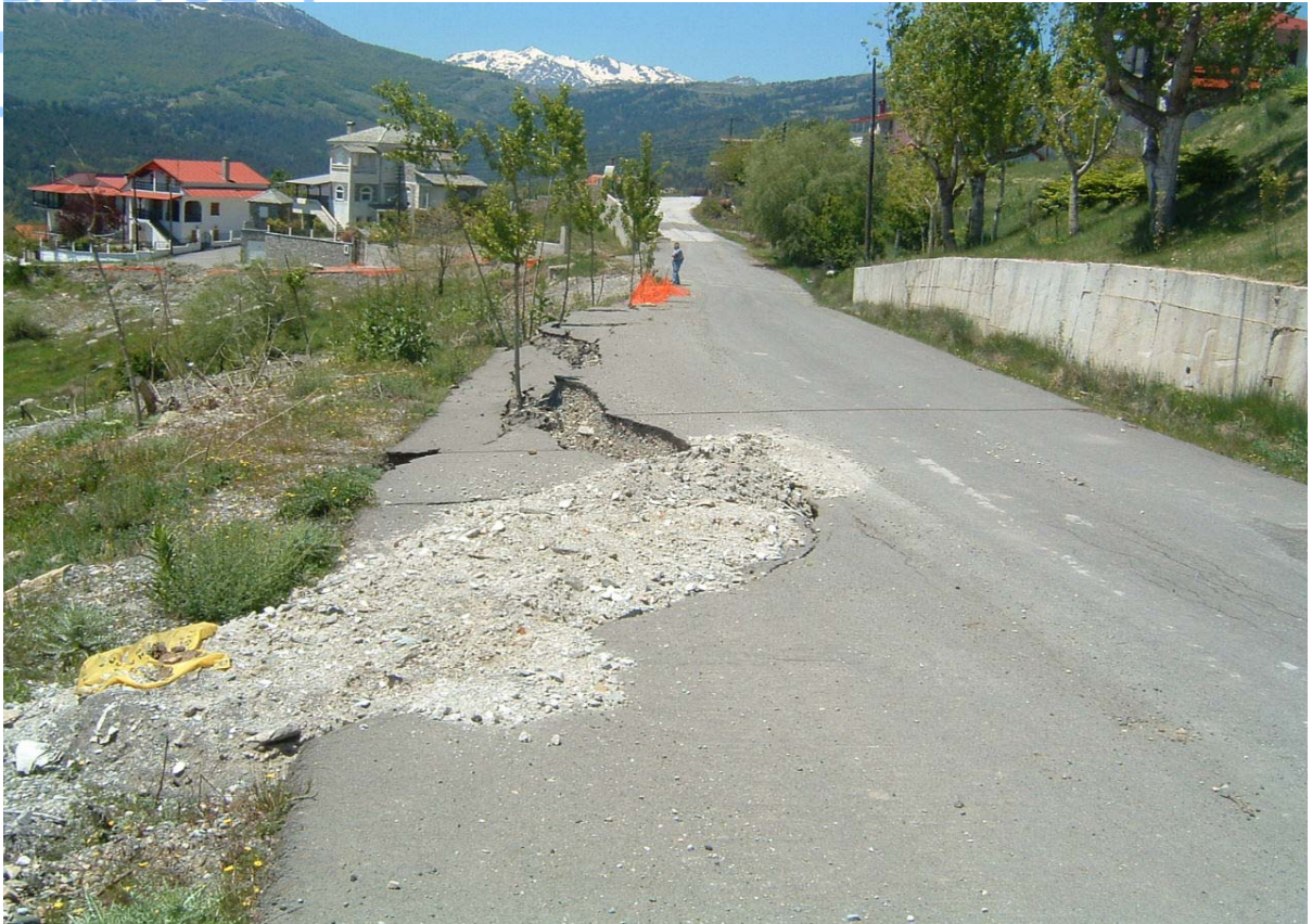
Φωτο 8: Καταστροφές σε έργα υποδομής του Οικισμού Κατολίσθηση Β.
