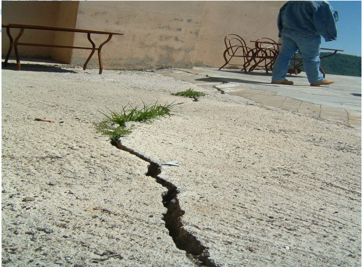
Φωτο 10: Ρωγμή σε Ξενώνα του Οικισμού στα πρνή της κατολίσθησης Β (Μπακόλας).
