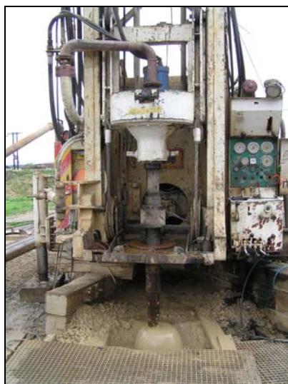
Εικόνα 41: Κεφαλή του γεωτρύπανου
