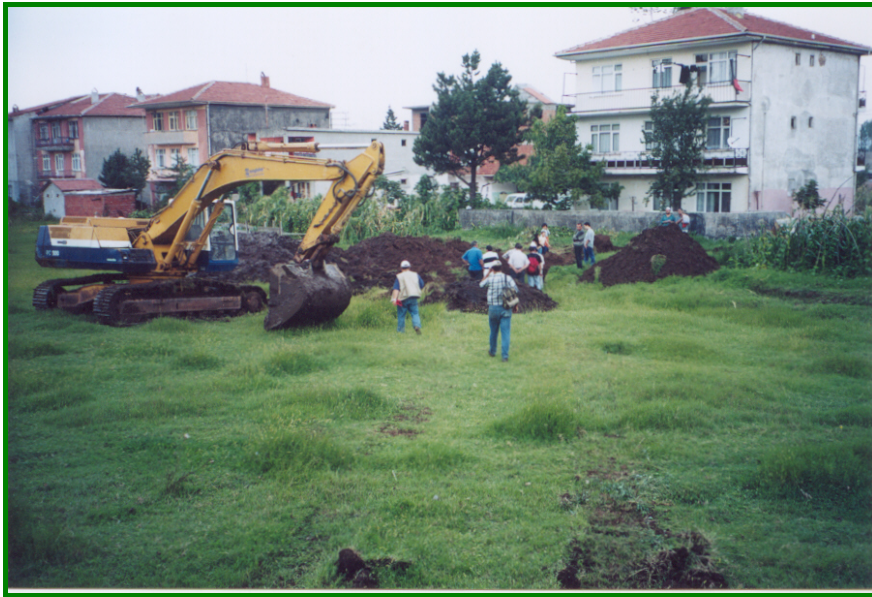
Εικόνα 4.5.2.5. Διάνοιξη της τομής ΑΥ-2, 40 m βόρεια της ΑΥ-1, στο σημείο όπου διερχόταν ένας παράλληλος κλάδος της σεισμικής διάρρηξης. Τα κτίρια που διακρίνονται στη φωτογραφία υπέστησαν πολύ περιορισμένες ζημιές.
