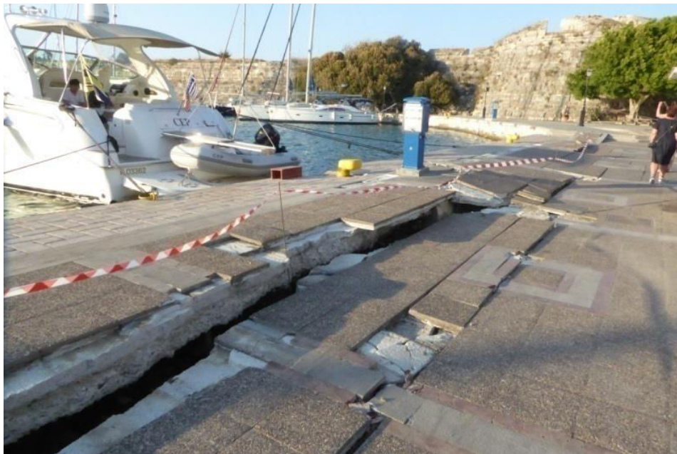
Εικόνα 10 Ρηγμάτωση σε δρόμο του Λιμανιού της Κω (Υαλζινερ et al.2017)
