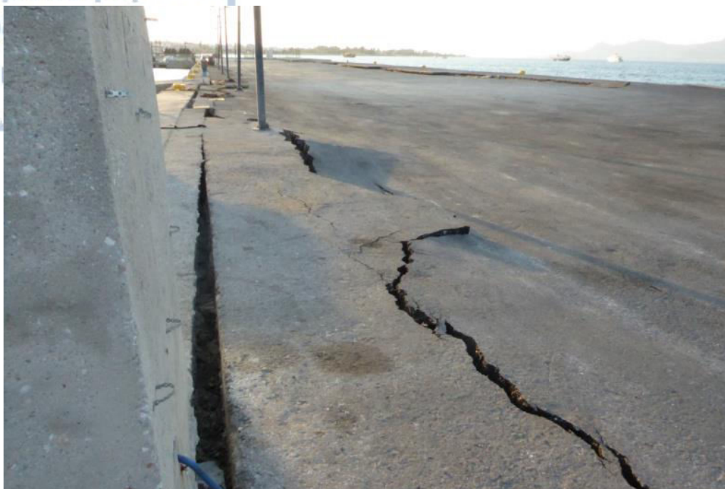
Εικόνα 7 Ρηγμάτωση σε δρόμο του Λιμανιού της Κω (Yalçiner et al. 2017)
