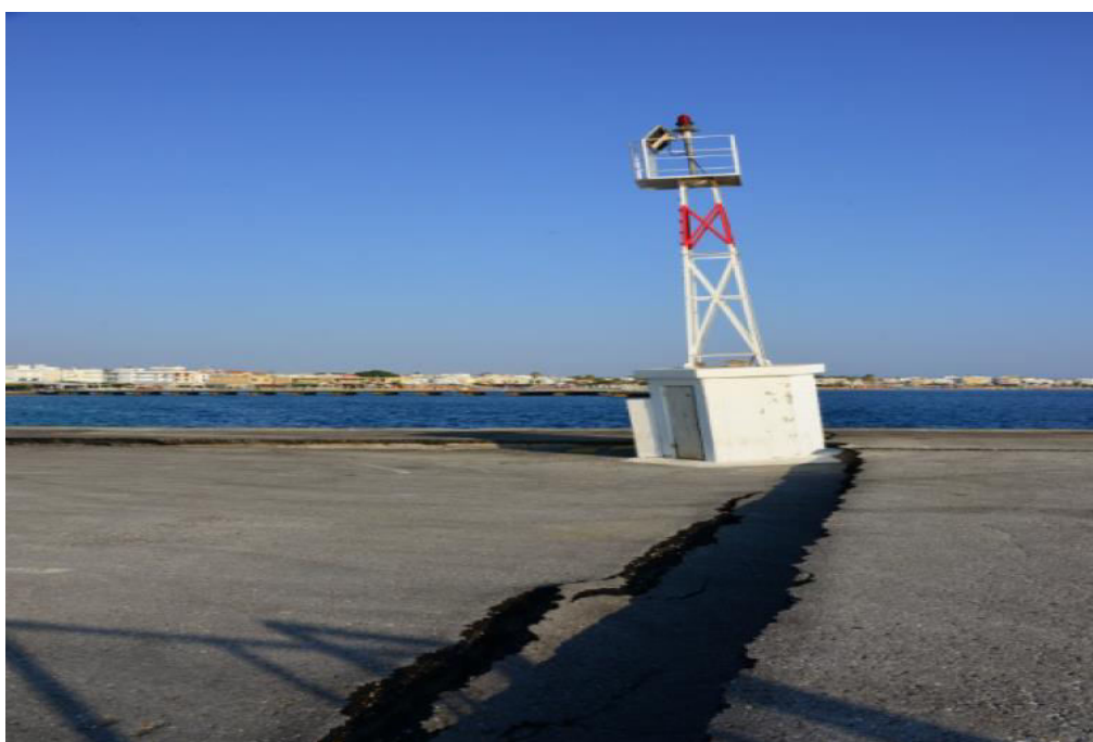
Εικόνα 8 Ρηγμάτωση σε δρόμο του Λιμανιού της Κω (Yalçiner et al. 2017)
