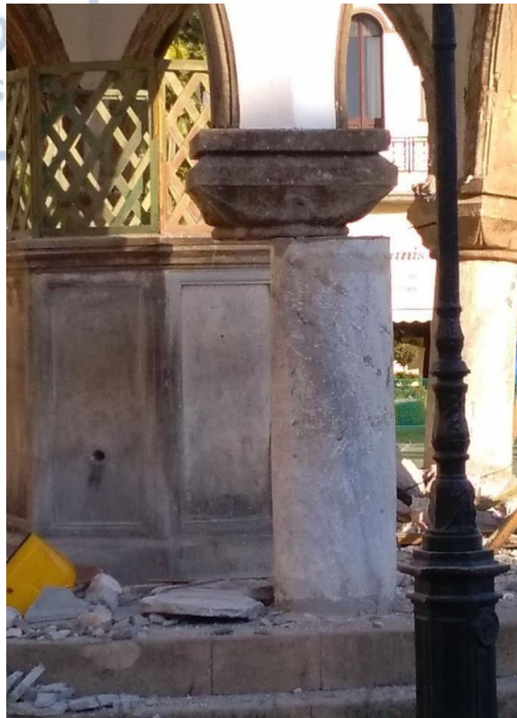
Εικόνα 9 Καταστροφή σε κολώνα Ναού (Υαλζινερ et al. 2017)
