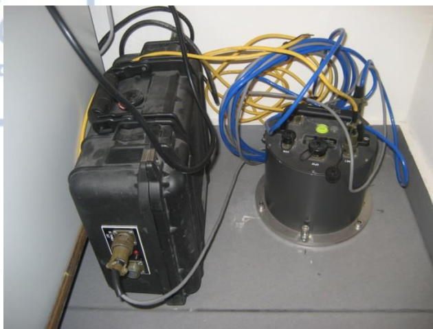
Σχ. 41. Εγκατάσταση επιταχυνσιογράφου τύπου Guralp CMG-5TD,
