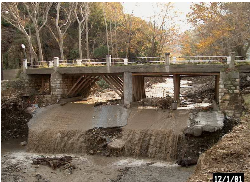
Φωτ. 5.5α Η διάβρωση κατόντη της γέφυρας του Κακορέμματος στην περιοχή «Πλατανάκια», μετά την πλημμύρα της 28-29/11/2001 (Βαβλιάκης κ.α., 2002).
