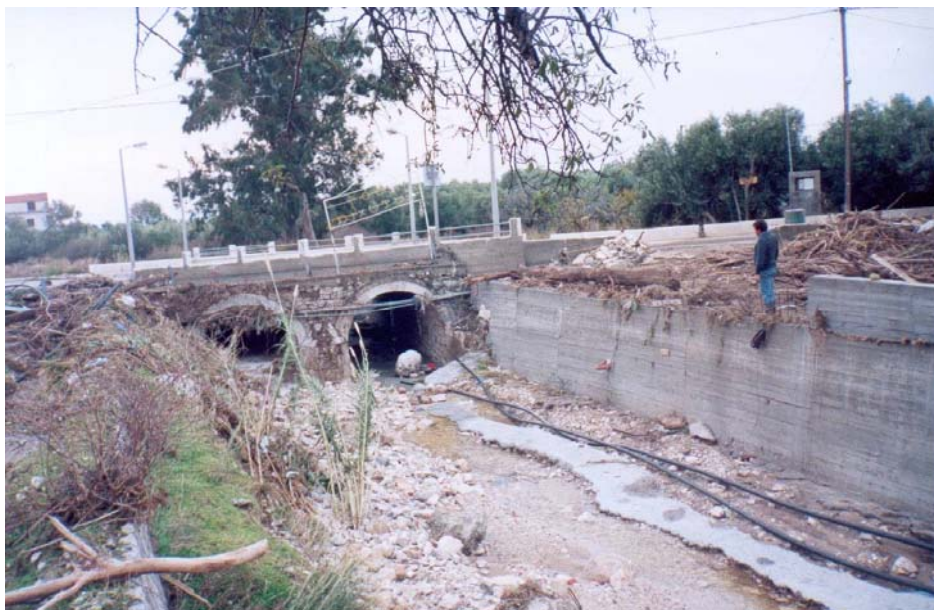
Φωτ. 5.2α Οι γέφυρες του χείμαρρου Καλαθή στην είσοδο του Δ.Δ Χώρας του Δήμου Πυθαγορείου, μετά την πλημμύρα της 28-29/11/2001. Φαίνεται η ανάντη πλευρά με τους κορμούς των δέντρων στις όχθες (Βαβλιάκης κ.α., 2002).
