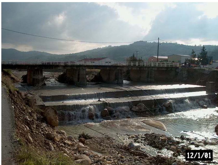
Φωτό 5.6β Η γέφυρα του Φουρνιώτικου ρέματος στην κατάντη πλευρά της, μετά την πλημμύρα της 28-29/11/2001. Φαίνονται καθαρά οι αναβαθμίδες για την απόσβεση της ροής οι οποίες λειτούργησαν κανονικά κατά τη διαδικασία εξέλιξης του φαινομένου (Βαβλιάκης κ.α., 2002).
