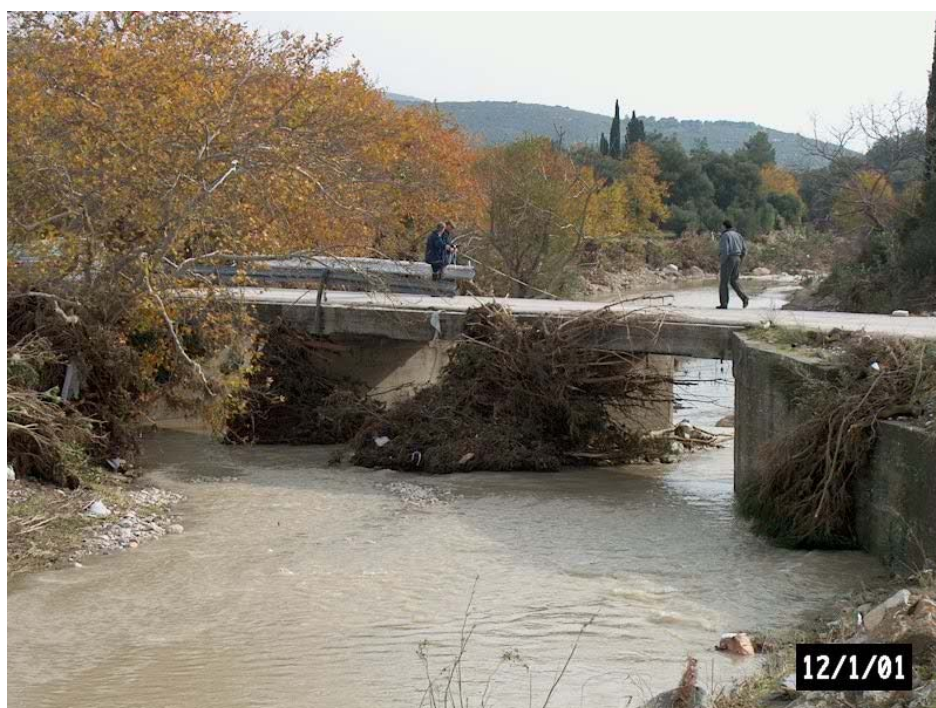
Φωτ. 5.3α Το γεφύρι του ρέματος Μυτιληνίων στην τοποθεσία «Μεσόκαμπος», μετά την πλημμύρα της 28-29/11/2001 (Βαβλιάκης κ.α., 2002).
