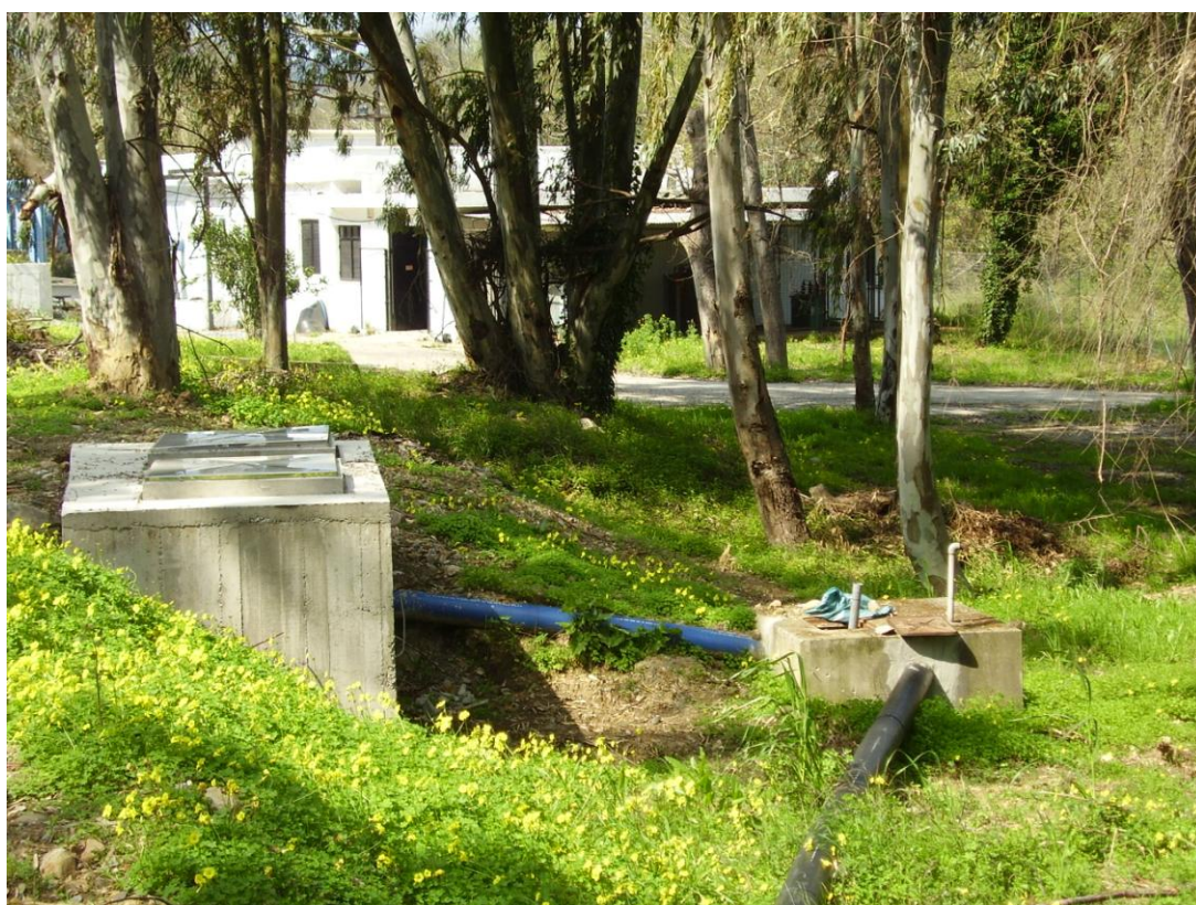
Φωτο. 4: Φρεάτιο Γεωτρήσεων στην Αγυιά (Η μπλέ σωλήνα είναι από την Πάνω γεώτρηση και η μαύρη από την Κάτω γεώτρηση)
