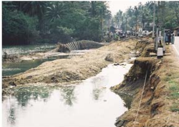
Σχήμα 4.10 : Ολική καταστροφή του σιδηρόδρομου εξαιτίας της πλευρικής επέκτασης και της κατάρρευσης του αναχώματος του που προκλήθηκε από την δράση της εδαφικής διάβρωσης του τσουνάμι (Abalangoda, νοτιοδυτική Σρι Λάνκα) [Papadopoulos et al., 2005].
