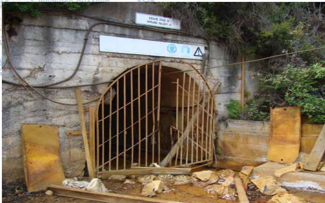
Εικ.12: Όξιμες απορροές παλιού μεταλλείου Στρατωνίου που οδηγούνται στο εργοστάσιο εμπλουτισμού
