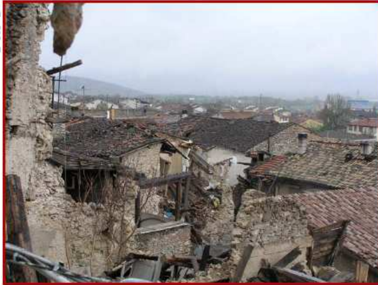
Σχήμα 2.5 Κατεστραμμένα πλινθόκτιστα σπίτια στη Paganica (Rossetto et al., 2009).
