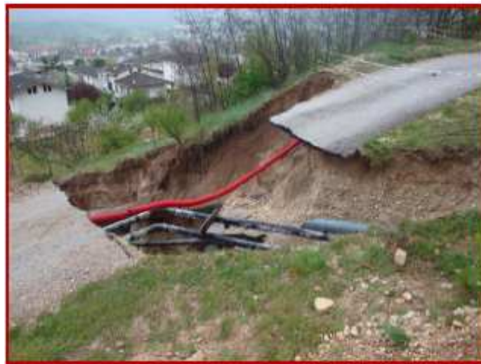
Σχήμα 2.18 Διερρηγμένος αγωγός νερού στη Paganica που προκάλεσε κατολίσθηση (Bazzurro et al., 2009).
