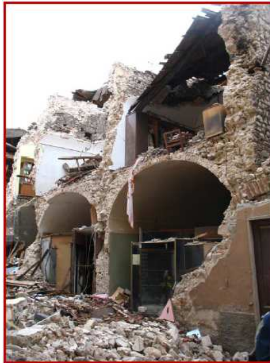
Σχήμα 2.14 Κατάρρευση ενός τυπικού πλινθόκτιστου τοίχου και ενός θολωτού ταβανιού (Rossetto et al., 2009).
