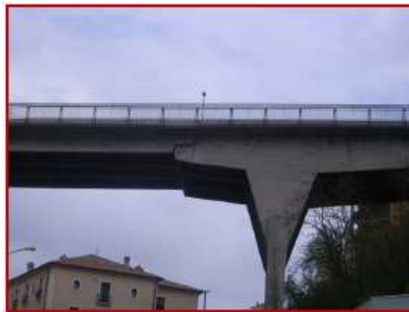
Σχήμα 2.16 Οδογέφυρα που υπέστη μετατόπιση στη θέση σύνδεσης με το υποστύλωμα (Bazzurro et al., 2009).
