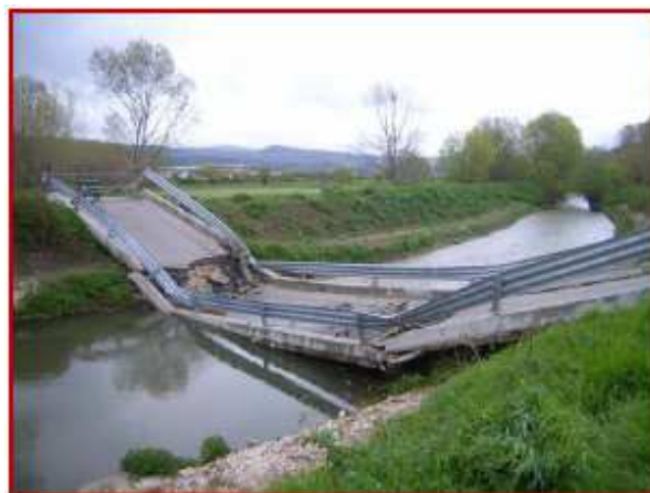
Σχήμα 2.17 Μικρή γέφυρα στη Fossa που κατέρρευσε (Bazzurro et al., 2009).
