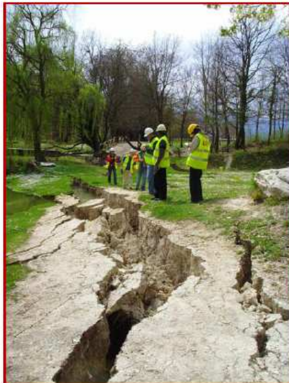
Σχήμα 2.11 Ρωγμές και βυθίσματα γύρω από λίμνη Sinizzo (Rossetto et al., 2009).
