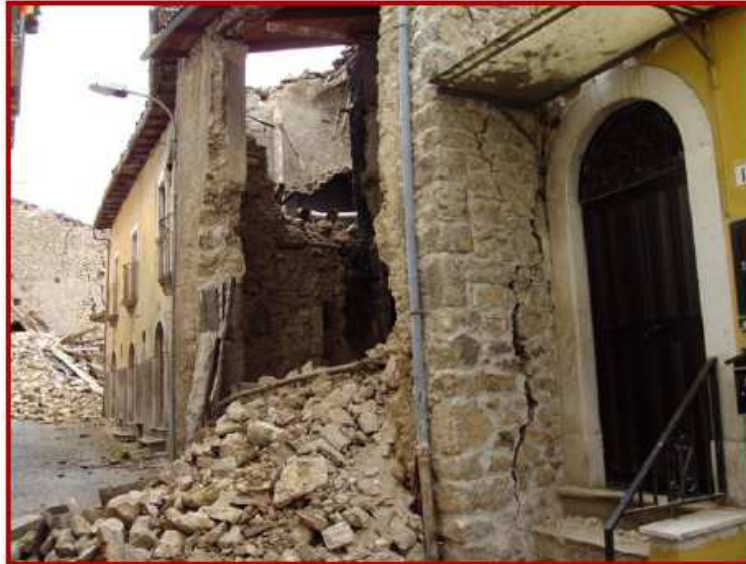
Σχήμα 2.7 Κατεστραμμένο πλινθόκτιστο κτίριο στο San Gregorio (Rossetto et al., 2009).
