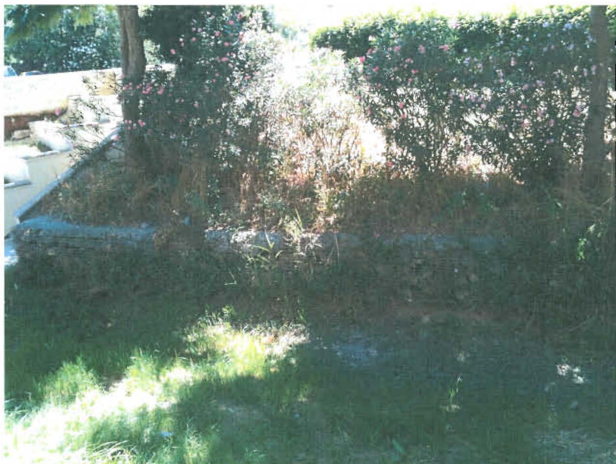
Συρματοκιβώτια κατά μήκος του ρέματος της Ν. Φώκαιας
