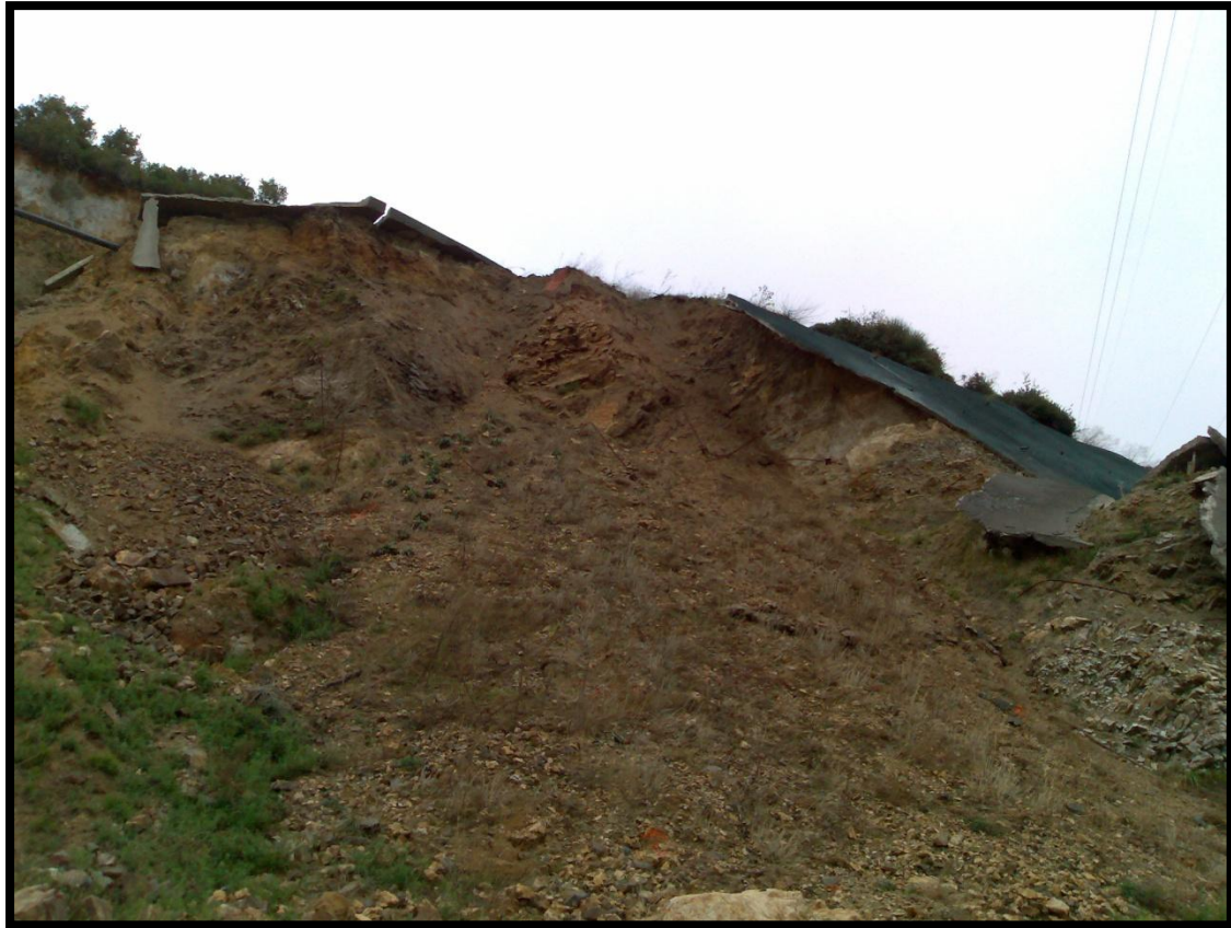
Εικόνα 5.2.4: Ολίσθηση στο κεντρικό τμήμα του ορύγματος περί τη Χ.Θ. 10+500 και εικόνα σχετικά υγιούς βραχομάζας στο δεξί κλάδο του ορύγματος
