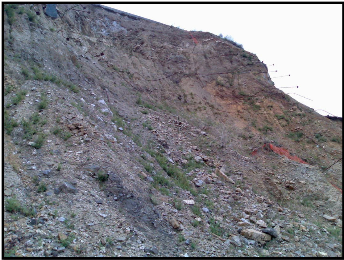
Εικόνα 5.6.1: Εικόνα αστοχίας στο πρανές της Χ.Θ. 10+500. Διακρίνονται αγκύρια βράχου που παραμένουν στη θέση αγκύρωσης έχοντας αστοχήσει
