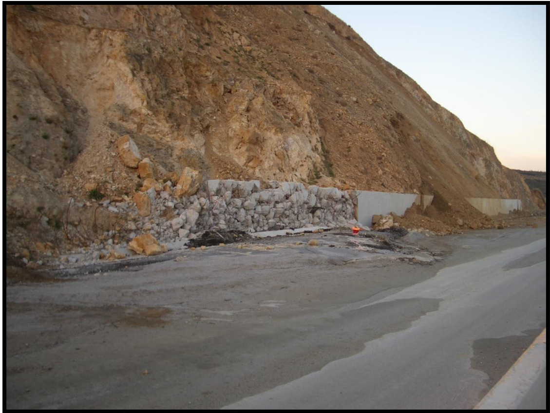
Εικόνα 5.2.7: Παραμόρφωση ασφαλτικού τάπητα και ρηγμάτωση τοίχου-βραχοπαγίδας στον πόδα του ορύγματος στη θέση 13+600
