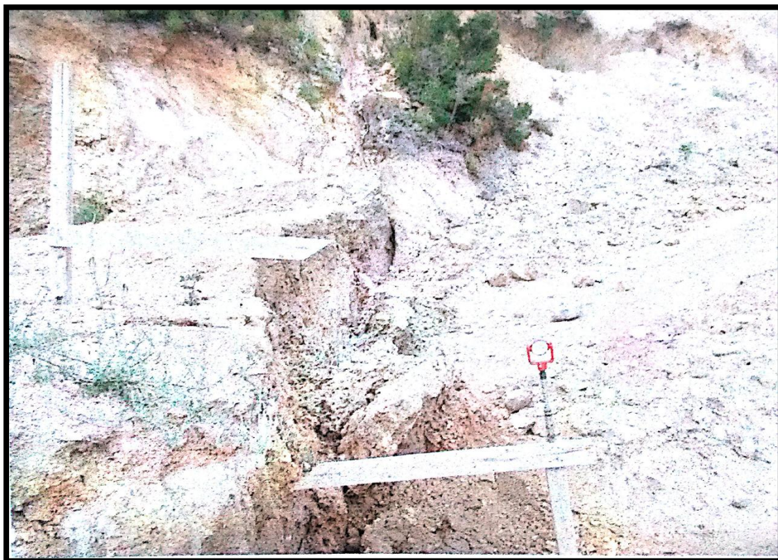
Εικόνα 5.2.8: Μάρτυρες μετακινήσεων στο φρύδι του πρανούς εκατέρωθεν της εφελκυστικής ρωγμής
