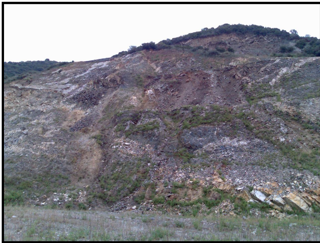
Εικόνα 5.2.3: Ολίσθηση τύπου "block" στο κεντρικό τμήμα του ορύγματος περί τη 10+300
