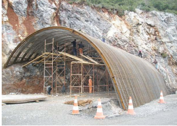
Εικόνα 4: Τοποθέτηση μεταλλικών πλαισίων και οπλισμού για την κατασκευή του εσωραχίου του αντίβαρου. Χρησιμοποιήθηκε εκτοξευόμενο σκυρόδεμα για την αποφυγή χρήσης μεταλλότυπου
