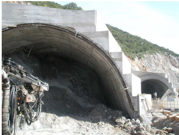
Εικόνα 5: Από την έναρξη των εργασιών εκσκαφής κάτω από το αντίβαρο του δεξιού κλάδου. Διακρίνεται το μεταλλικό πλαίσιο του σύμμεικτου εσωραχίου. Στο βάθος διακρίνεται το αντίβαρο του αριστερού κλάδου.
