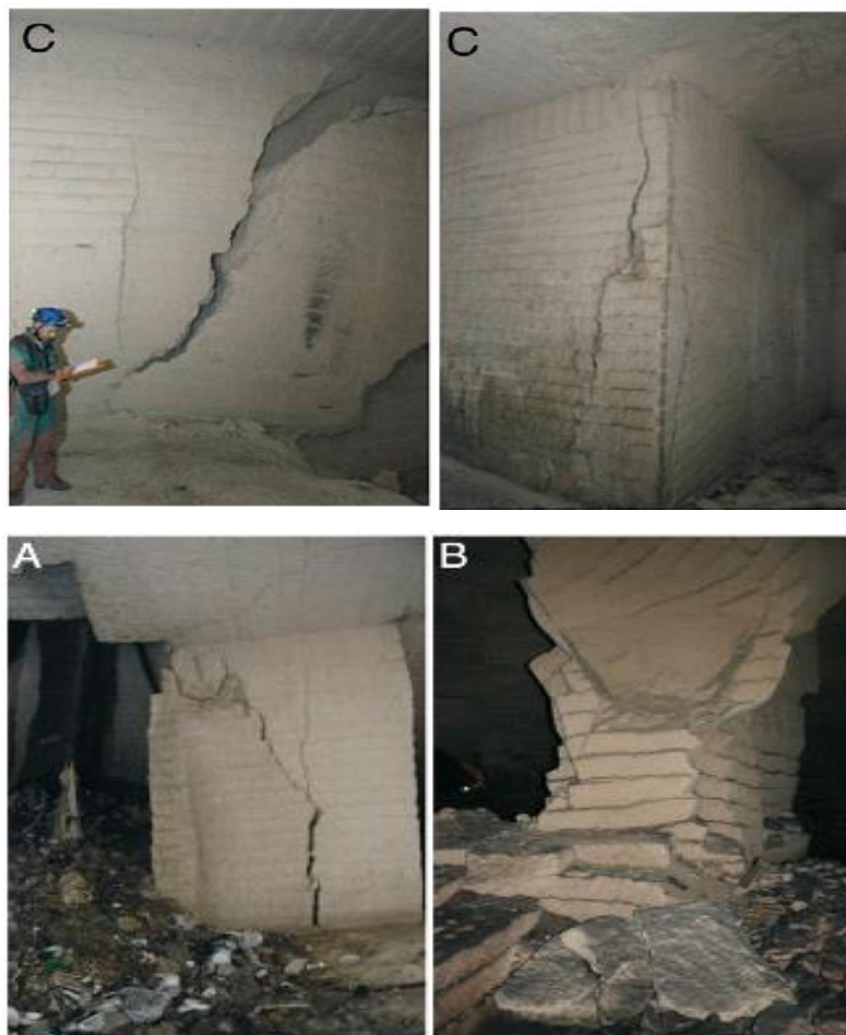
Σχήμα 2.4 Μηχανικές αστοχίες σε τοίχους και κολώνες στήριξης λόγω καρστικών φαινομένων (Parise & Lollino, 2011).
