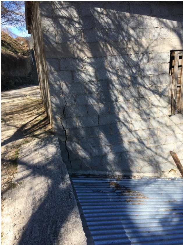
Εικόνα 5.6 Ρωγμή σε σπίτι του Μετσόβου
