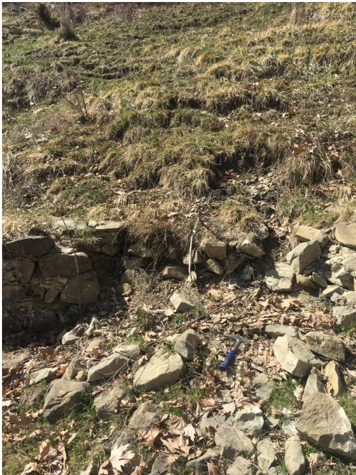
Εικόνα 5.15 Αστοχία στο τοιγάκι
