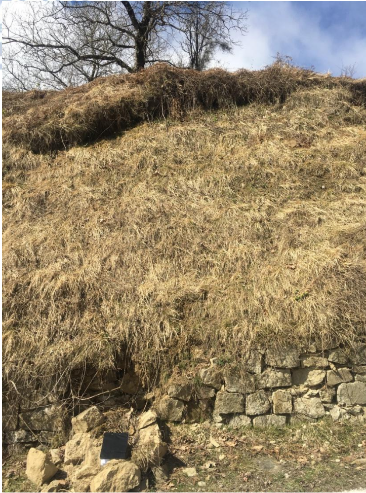
Εικόνα 5.14 Φρύδι μικρότερης κατολίσθησης και αστοχία στο φράχτη
