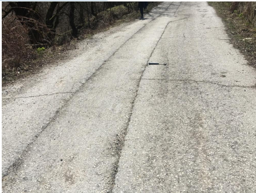
Εικόνα 5.22 Θραύσεις στον δρόμο
