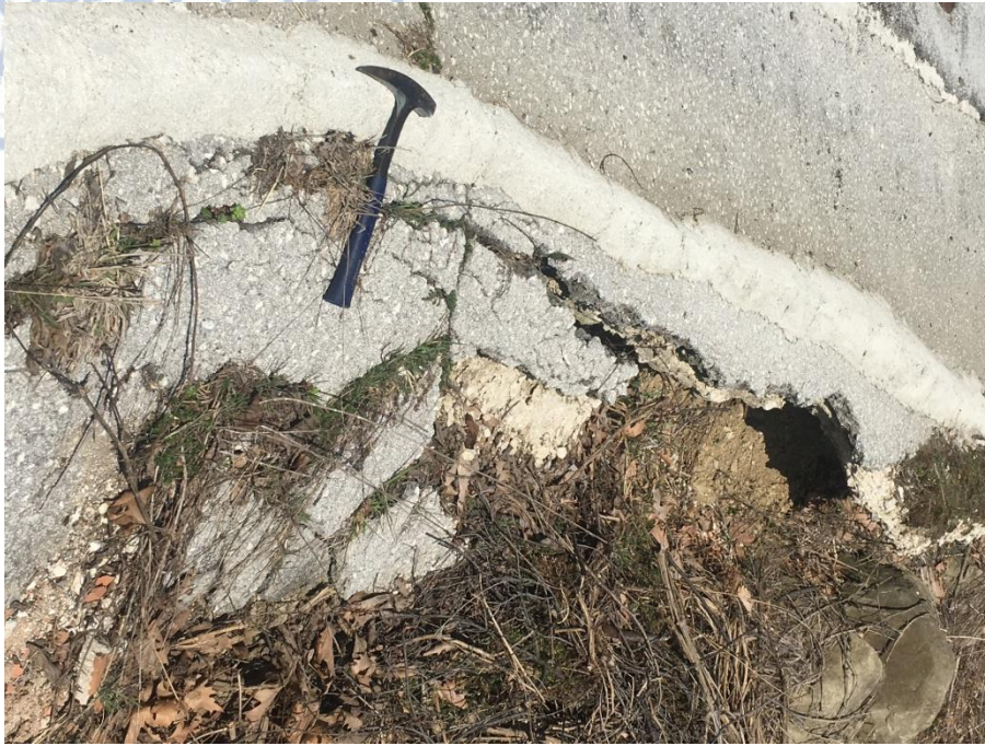
Εικόνα 5.15 Αστοχία στον δρόμο
