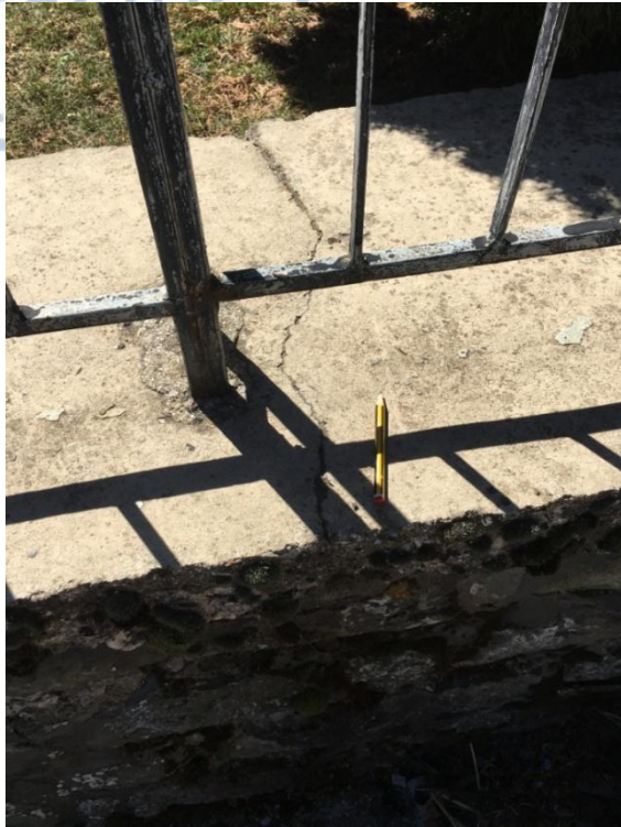
Εικόνα 5.2 Η ρωγμή η οποία συνεχίζει προς τον εσωτερικό τοίχο της εκκλησίας
