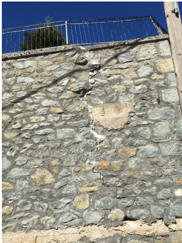
Εικόνα 5.3 Ρωγμή στον τοίχο κάτω από την εκκλησία
