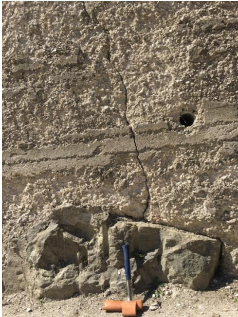
Εικόνα 5.4 Ρωγμή σε σπίτι
