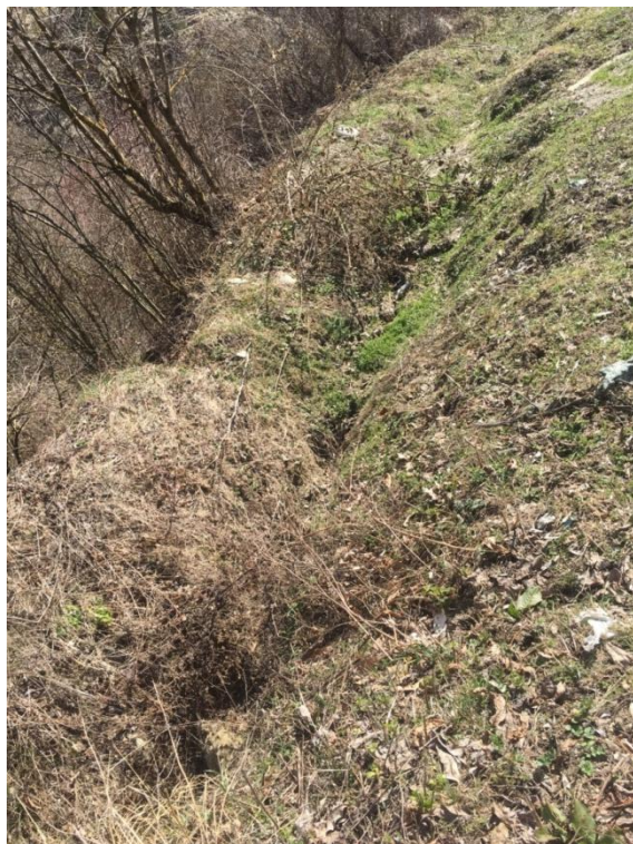
Εικόνα 5.18 Φούσκωμα στο ρέμμα της περιοχής
