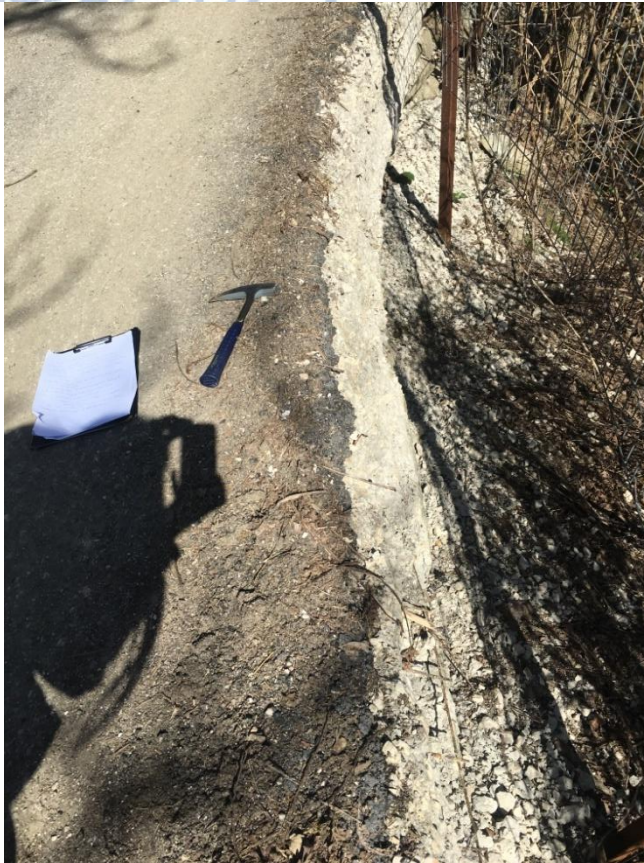
Εικόνα 5.16 Αστοχία στον δρόμο
