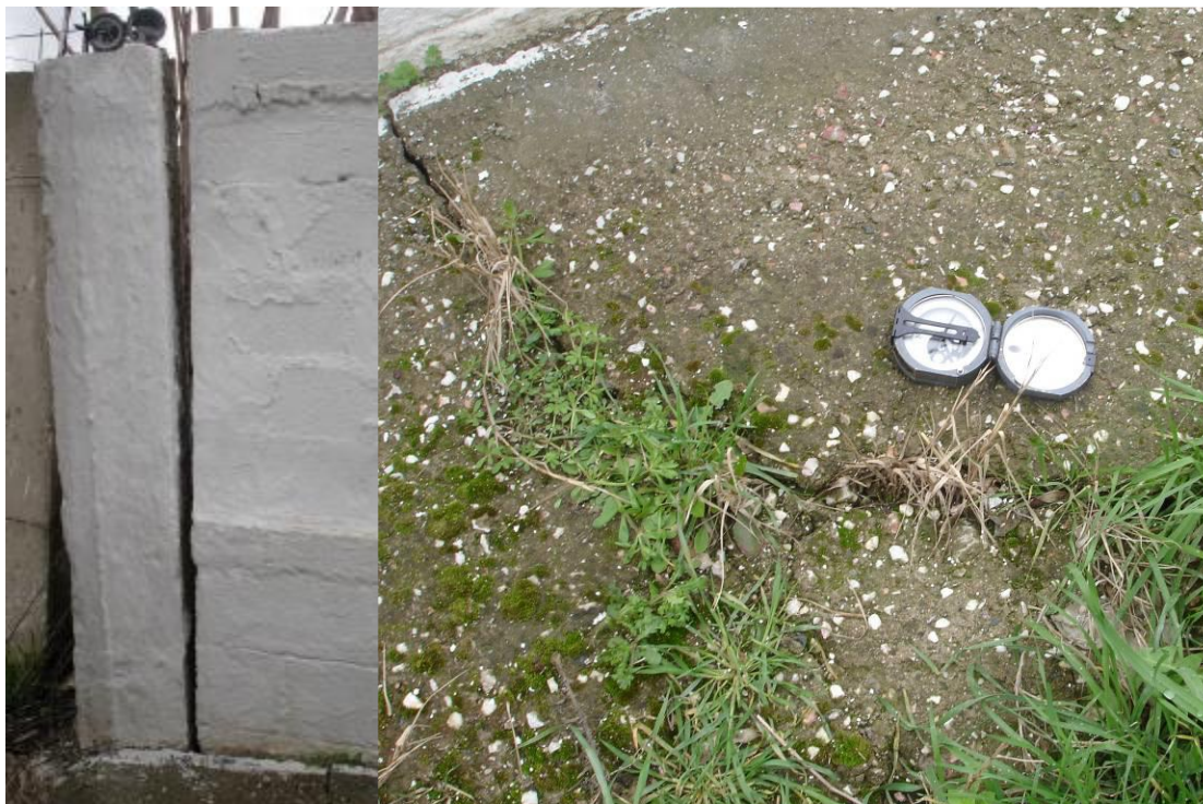
Εικόνα 6: Αποκόλληση κολώνας περιφράξης με οριζόντιο άνοιγμα 5cm στην κορυφή και 3cm στη βάση της, ενώ φέρει και αριστερόστροφη κατακόρυφη μετατόπιση 12cm. Στα θεμέλια της κολώνας (δεξιά) παρατηρείται ρωγμή με παράταξη 130° και άνοιγμα 0.2cm. (Χατζηπέτρος, 2006)
