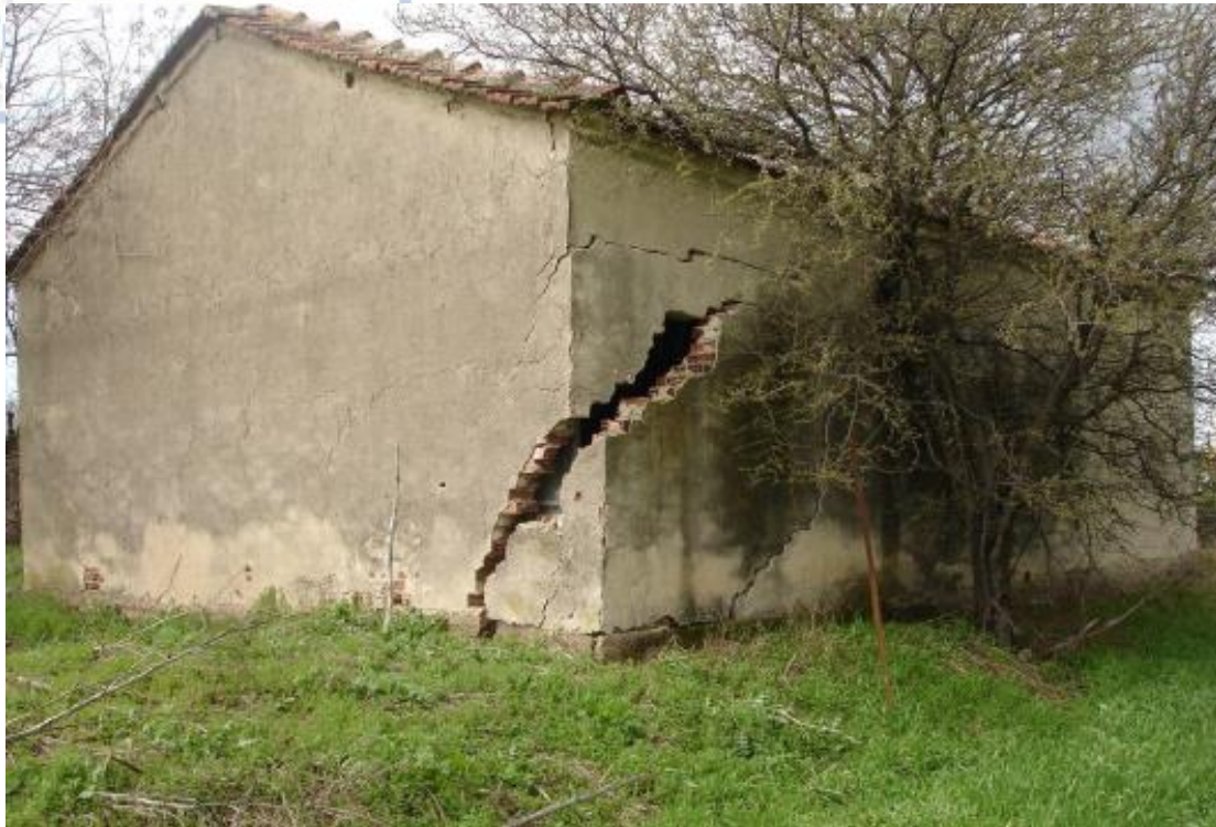
Εικόνα 3: Άποψη κτιρίου όπου διακρίνονται μεγάλες παραμορφώσεις στη ΒΑ πλευρά του, ενώ εμφανής είναι και η οριζόντια αριστερόστροφη περιστροφή. (Χατζηπέτρος, 2006)
