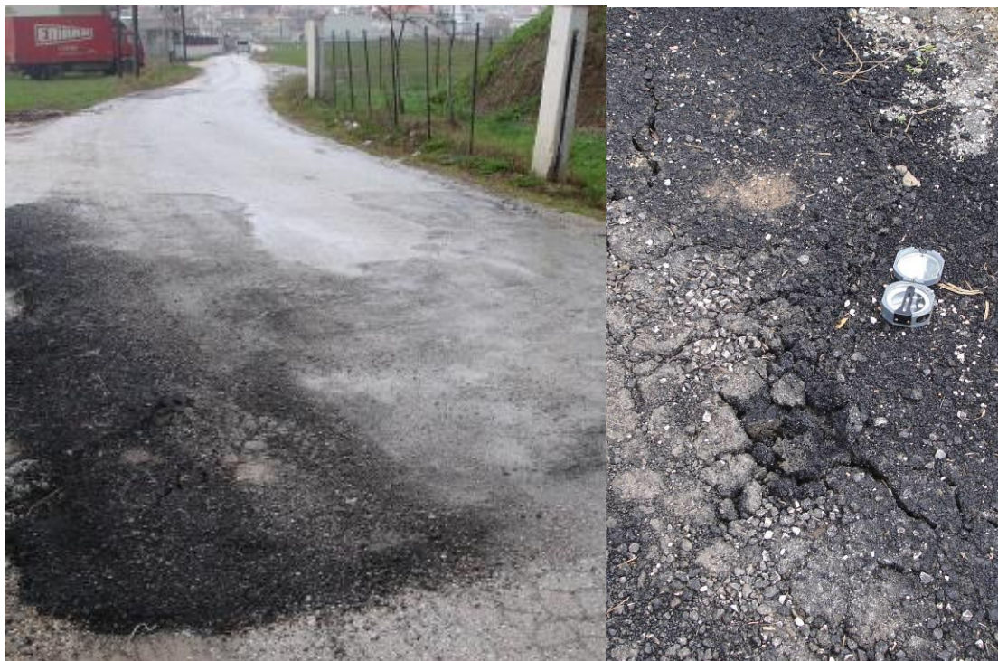
Εικόνα 4: Επιφανειακή διάρρηξη σε δρόμο του οικισμού όπου έγινε προσπάθεια επιδιόρθωσης της ασφάλτου, αλλά επηρεάστηκε από νεότερη διάρρηξη (δεξιά), γεγονός που δείχνει την συνεχή εξέλιξη του φαινομένου με τα χρόνια. Διακρίνεται επίσης και η παραμορφωμένη κολώνα. Και οι δυο ζημιές φαίνεται να έχουν την ίδια παράταξη. (Χατζηπέτρος, 2006)
