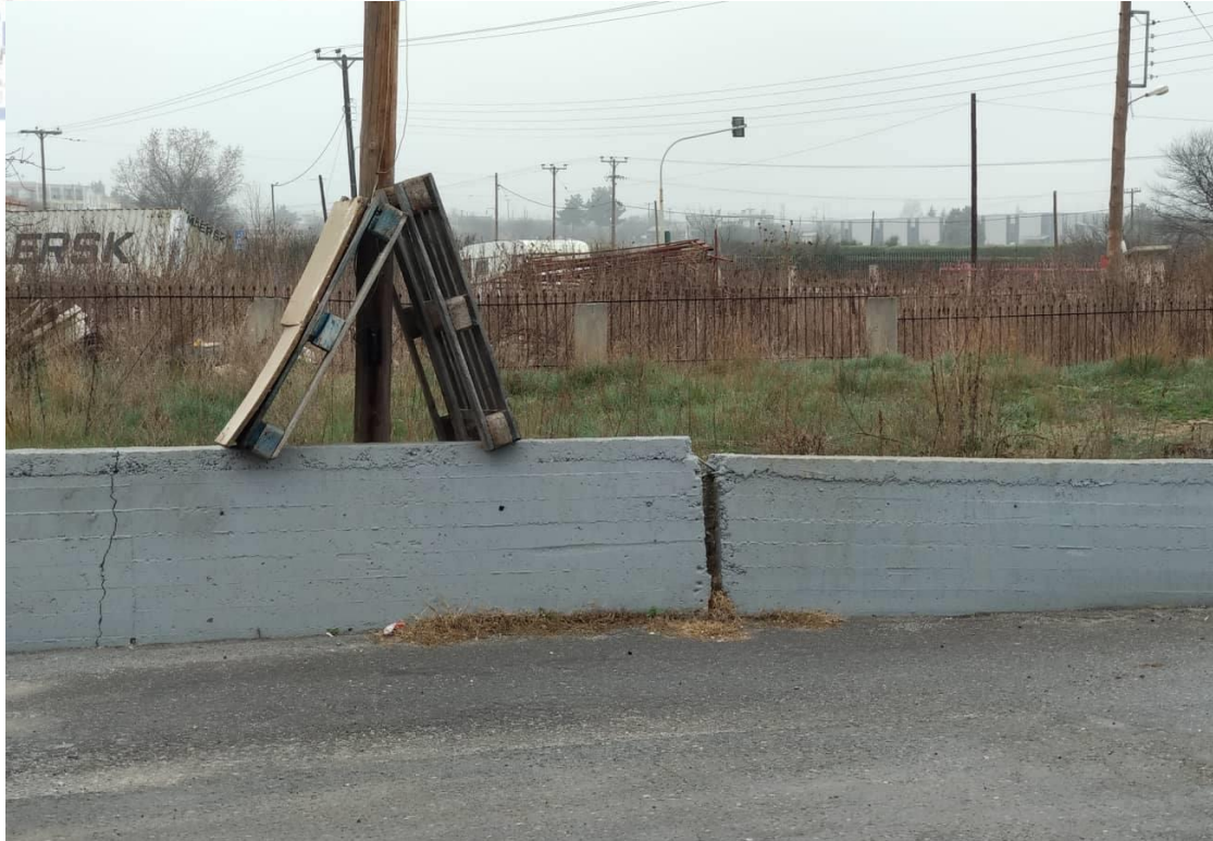
Εικόνα 9: Εμφανής κατακόρυφη και οριζόντια μετατόπιση της τσιμεντένιας περίφραξης στα ΒΔ του καταστήματος «ΕΓΝΑΤΙΑ». Παράλληλα σε αυτή τη περίφραξη εκτελέστηκαν οι μετρήσεις στη τομή L1. (Chatzipetros & Papadopoulou, 2019)
