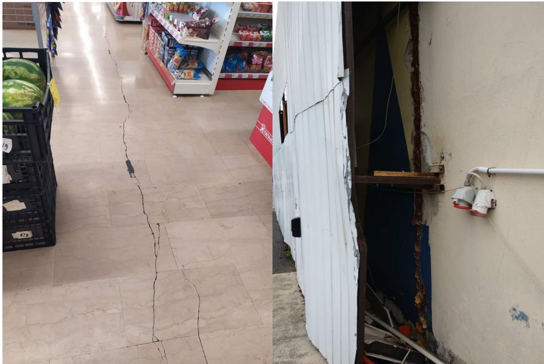
Εικόνα 8: Διάρρηξη στο εσωτερικό του καταστήματος «ΕΓΝΑΤΙΑ» (αριστερά) Εμφανής αποκόλληση της ένωσης της ΒΔ τοιχοποιίας (δεξιά) του ίδιου καταστήματος με το σκελετό του κτιρίου. (Chatzipetros & Papadopoulou, 2019)
