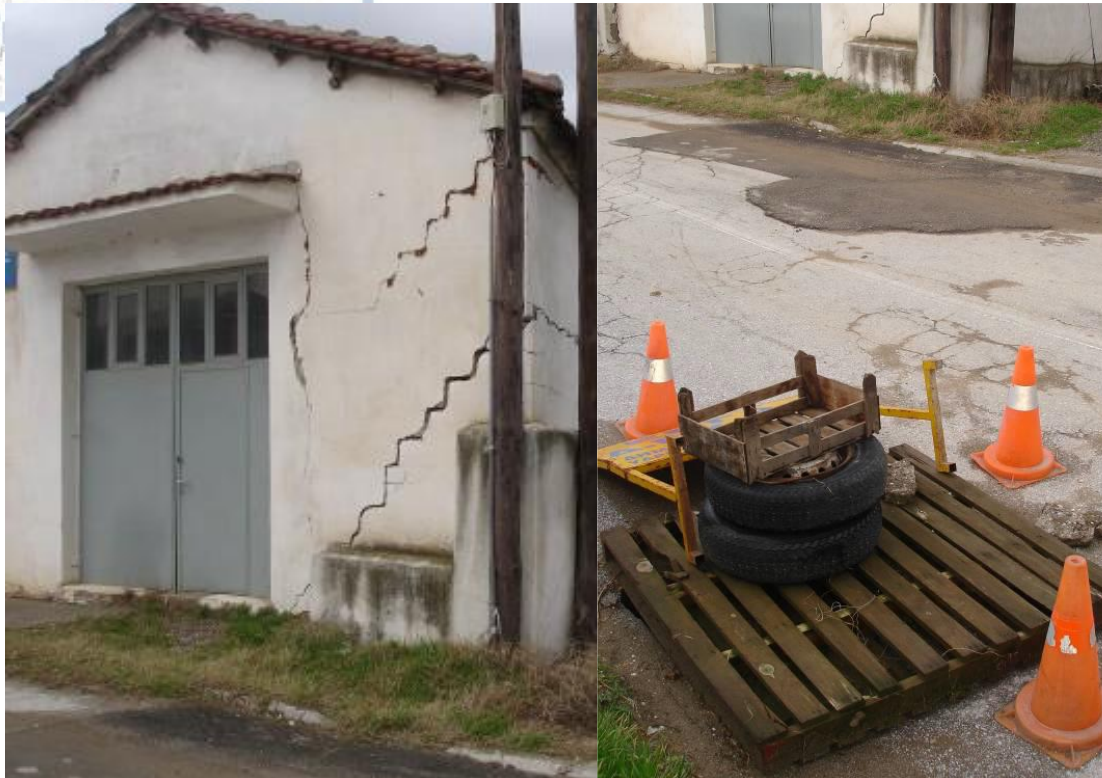
Εικόνα 5: Εμφανής αποκόλληση δομικών υλικών σε αποθήκη η οποία σε πιο πρόσφατη έρευνα δεν συναντάται πια στη συγκεκριμένη θέση, ενώ στον δρόμο μπροστά από το κτίσμα διακρίνονται απόπειρες επιδιόρθωσης του οδοστρώματος. (Χατζηπέτρος, 2006)
