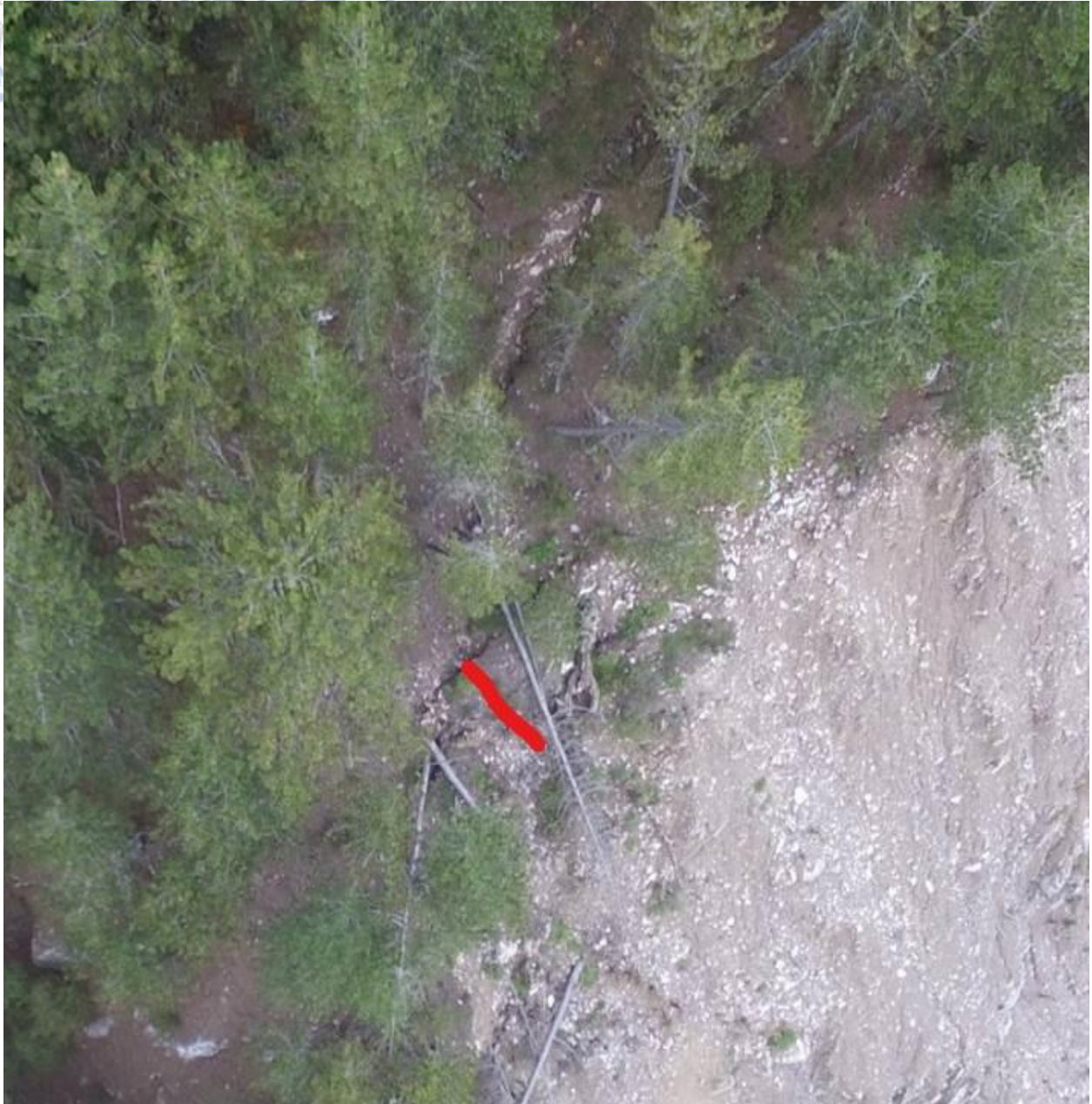
Φωτογραφία 5.3: Η εφελκυστική ρωγμή σε απόσταση 5m. πίσω από τη στέγη του πρανούς αποτελεί πολύ σημαντικό δείκτη ενεργούς κατολίσθησης.
