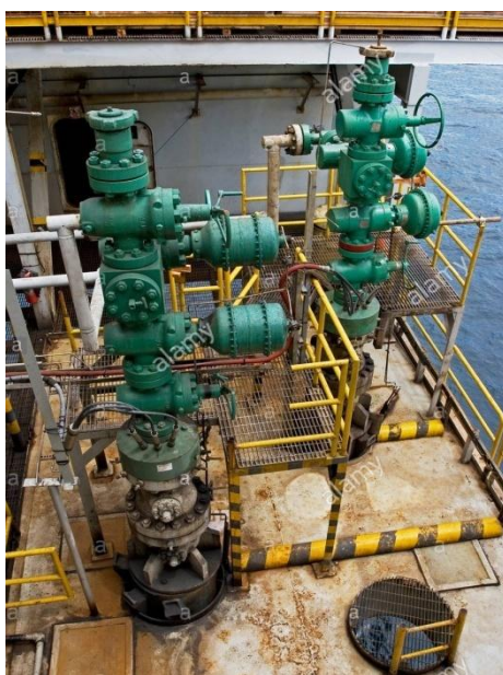
Εικόνα 5 - Dry Christmas Tree πάνω σε υπεράκτια πλατφόρμα παραγωγής υδρογονανθράκων [πηγή: https://www.alamy.com/ ]
