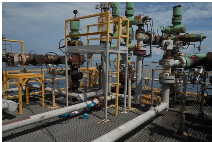
Εικόνα 6 - Εξοπλισμός επιφανείας Wellhead σε υπεράκτια παραγωγή φυσικού αερίου [ https://www.exprogroup.com/ ]
