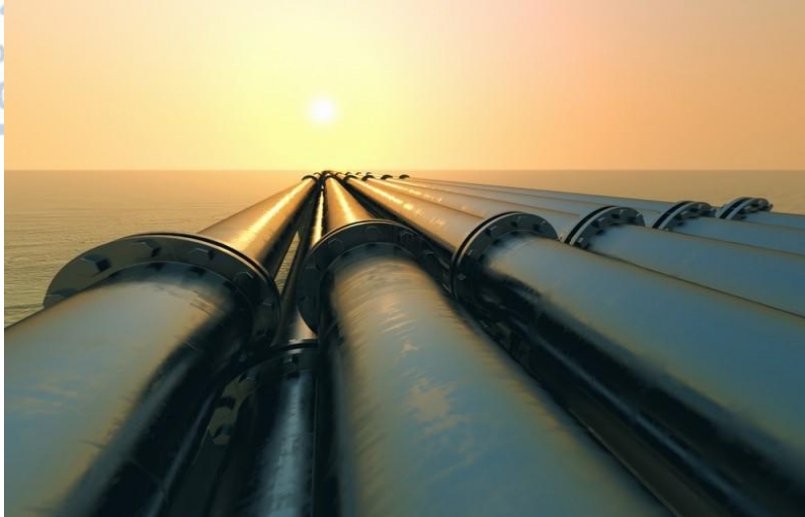
Εικόνα 36 - Αγωγοί μεταφοράς από θαλάσσιες γεωτρήσεις [πηγή: https://www.stockinvestor.com/ ]
