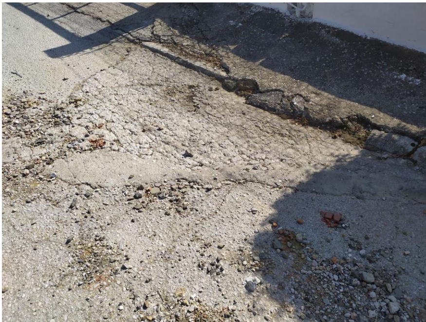
Εικόνα 2. Ζημιές και παραμορφώσεις που έχουν προκληθεί σε κεντρικό δρόμο μέσα στο χωριό των Λαγυνών.
