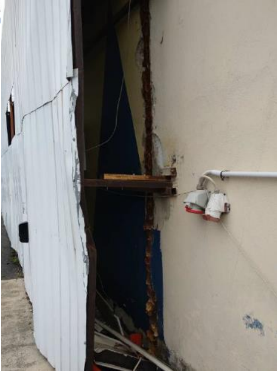
Εικόνα 5. Εμφανής αποκόλληση της ένωσης της ΒΔ τοιχοποιίας του καταστήματος «ΕΓΝΑΤΙΑ» με το σκελετό του κτιρίου.
