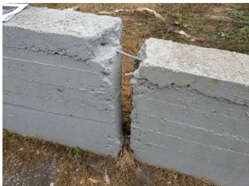
Εικόνα 11. Παραμόρφωση τοιχίου στην περιοχή των Λαγυνών, 50 m νότια της Παλαιάς Εθνικής Οδού Θεσσαλονίκης – Καβάλας.
