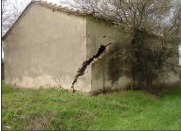
Εικόνα 9. Ζημιές που προκλήθηκαν από τη δράση των επιφανειακών διαρρήξεων σε κτήριο μέσα στον οικισμό των Λαγυνών. (Chatzipetros et al., 2005).
