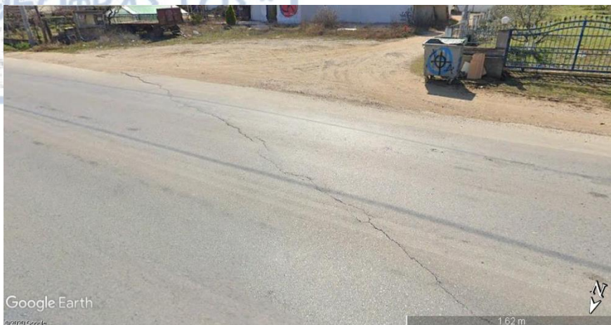
Εικόνα 31. Παραμόρφωση της ασφάλτου της παλαιάς εθνικής οδού Θεσσαλονίκης – Καβάλας με τη μορφή en échelon μικρών διαρρήξεων διεύθυνσης ΒΔ – ΝΑ
