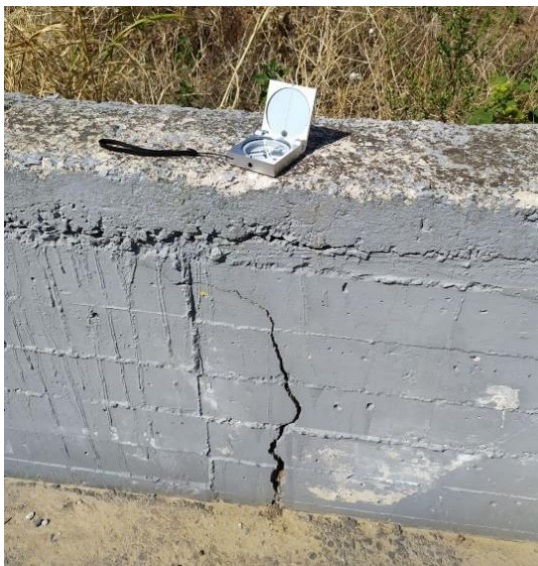
Εικόνα 7. Ρωγμή στο τοιχίο του καταστήματος «Εγνατία». Το μέγιστο άνοιγμά του υπολογίστηκε στα 1,2 cm.
