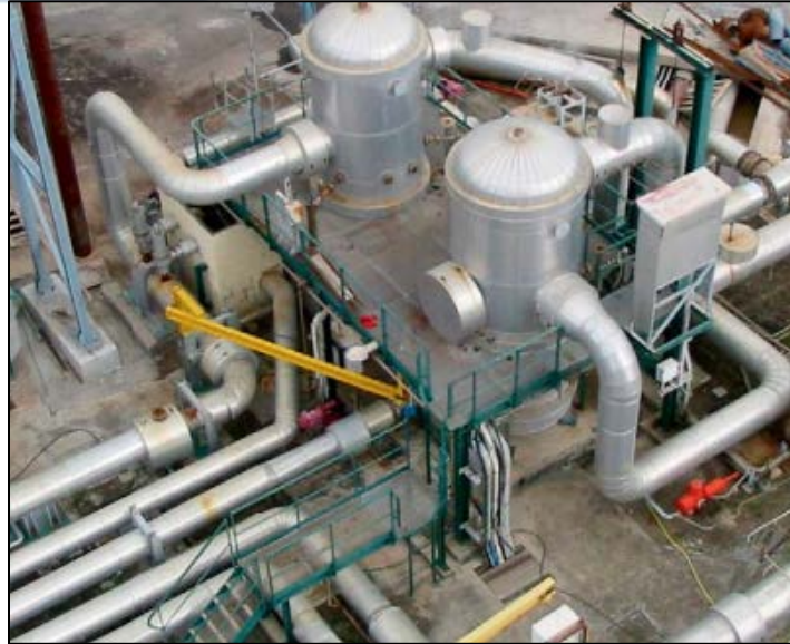
Εικόνα 31: Γεωθερμικός σταθμός Bouillante στη Γαλλία ( www.repowermap.org )
