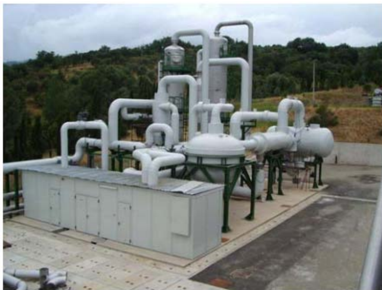
Εικόνα 25: Μονάδα AMIS στον σταθμό ηλεκτροπαραγωγής Pianstagnaio 3 στην περιοχή Monte Amiata (Bonciani et al., 2013)
