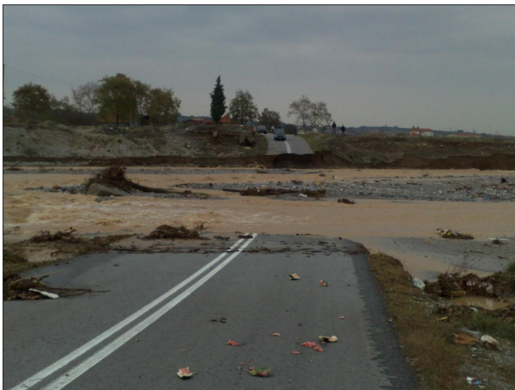
Φώτο 6.2 Προβλήματα σε πλημμυρισμένο δρόμο στην διάβαση Ξερολακκίου Κονταρριώτισσας – Αγ.Σπυρίδωνα(Οκτ, 2009) ( www.pieria.gr ).
