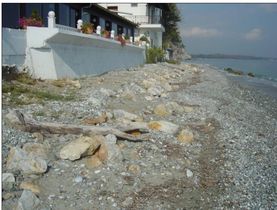
Φώτο 7.9. Θέση 23. Διάβρωση κάτω από το κάστρο του Πλαταμώνα.
